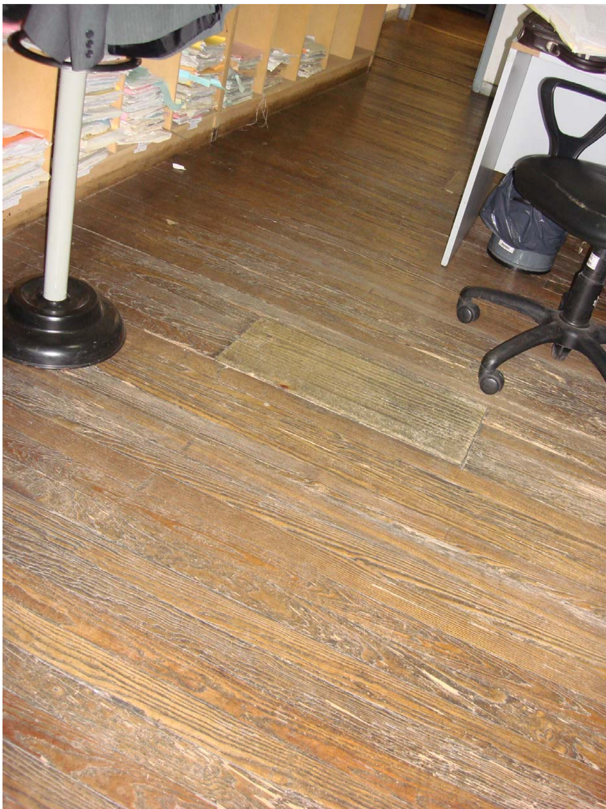
Foto N° 67: Observamos en la presente vista el piso de madera de pinotea de una oficina del 7º piso muy deteriorado.
