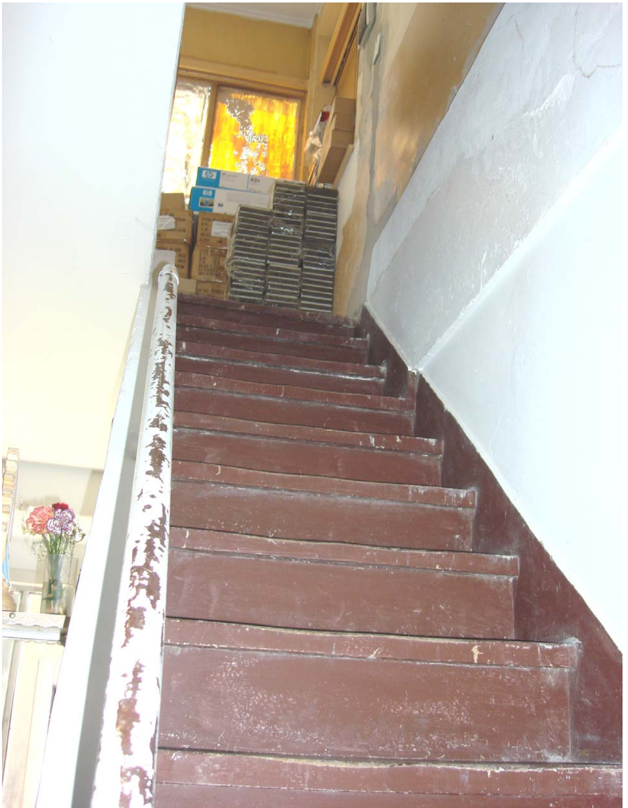
Foto N° 27: Observamos en la presente vista la escalera de 80 cm. de ancho que sube del 9º piso a la oficina de mantenimiento en la terraza (el mínimo ancho para locales de 1ª deben ser de 1 m).
