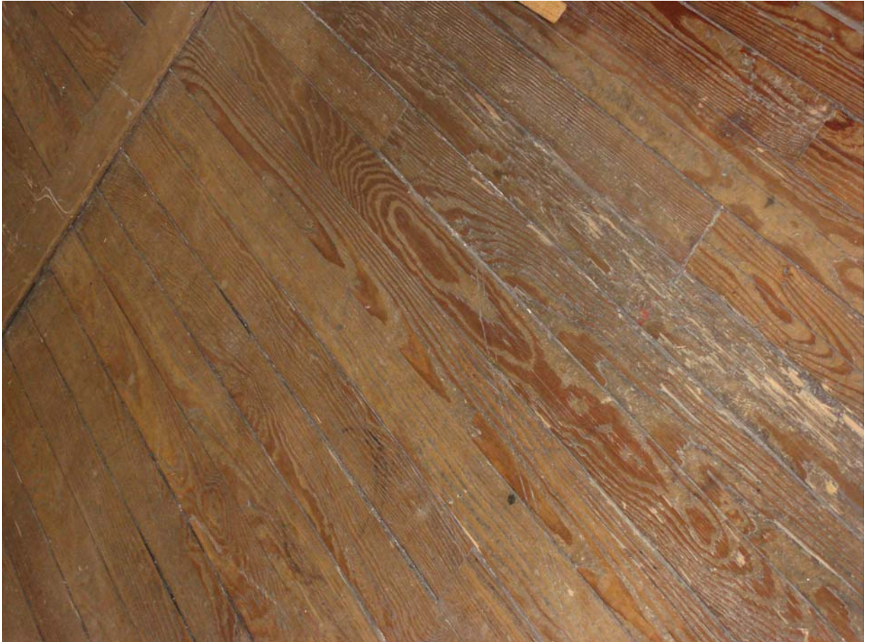
Foto N° 72: Observamos en la presente vista de una oficina del 7º piso el solado de madera de pinotea muy deteriorado y por sectores se hunde al paso de la gente.
