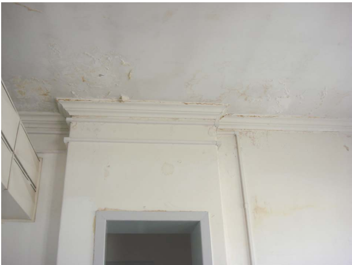
Foto N° 45: Observamos en la presente vista un local del 9° piso rastros de humedad generalizado en el techo y las paredes.
