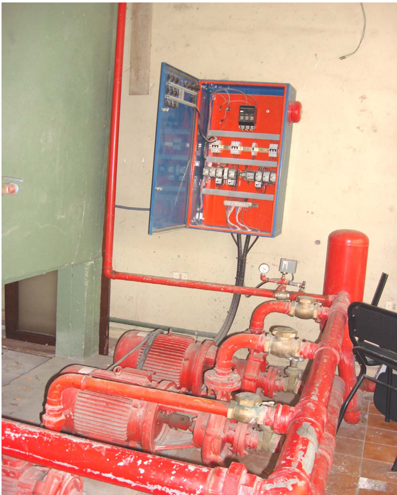
Foto N° 101: Observamos en la presente vista del local de planta baja donde esta el equipo de bombeo contra incendio, que no funciona, y atrás vemos el tablero de electricidad que opera estos equipos sin la contratapa reglamentaria y con varios cables de electricidad expuestos. A la derecha se ven restos de sillas y material de rezago depositados en este local.
