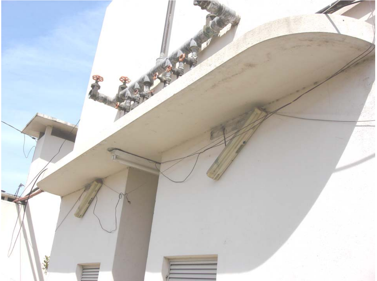
Foto N° 42: Observamos en la presente vista de la terraza, en la parte superior el tanque de reserva y debajo del alero que cubre la salida a este nivel varios cables de electricidad expuestos que cuelgan y alimentan a un artefacto de iluminación con un tubo fluorescente y a los costados dos artefactos de la luz de emergencia que cuelgan fuera del lugar de su ubicación normal.
