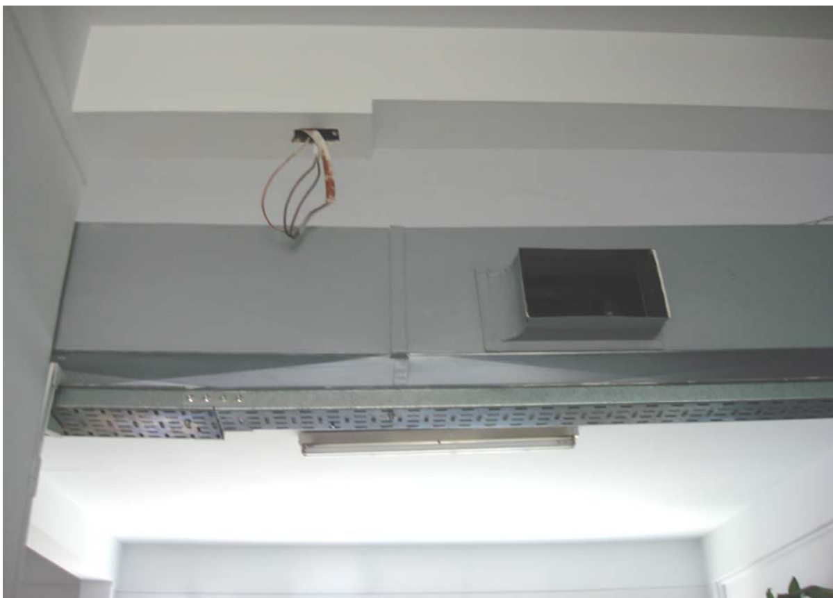
Foto N° 71: Observamos en la presente vista en un ducto de AA una boca de salida del aire “tapada” por no poderse regular ni el caudal ni el frío, mas arriba a la izquierda, de un orificio en el cielorraso salen varios cables de electricidad expuestos y encintados .
