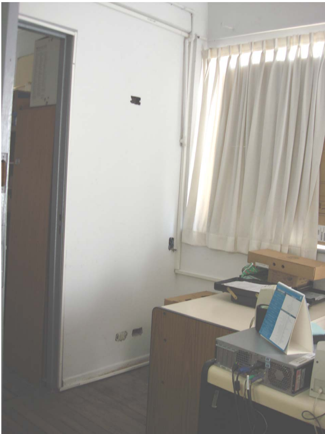
Foto N° 22: Observamos en la presente vista sobre una pared de una oficina del 9º piso cuatro bocas sin tapas de las que salen cable de electricidad expuestos.
