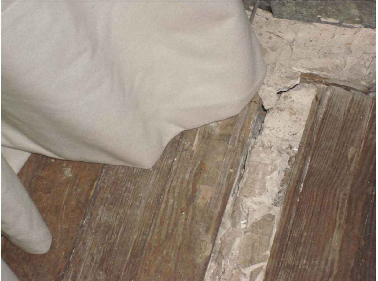
Foto N° 80: Observamos en la presente vista en una oficina del 6º piso el solado de madera de pinotea muy deteriorado le faltan algunas tablillas donde había una pared en ese lugar colocaron en reemplazo un contrapiso de material que en este momento presenta falta de este material las tablas separadas de la pared.
