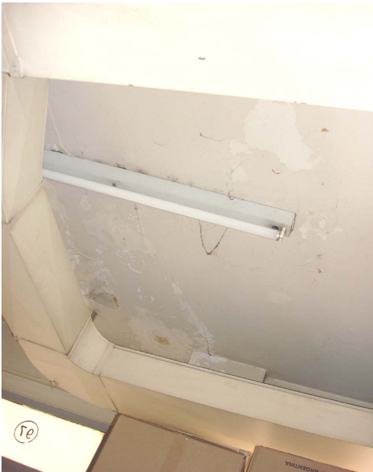
Foto N° 31: Observamos en la presente vista en una oficina del 9º piso un artefacto de iluminación con un tubo fluorescente sin la protección ante caída del mismo, el que pasa sobre una tubería de AA y en el cielorraso marcas de humedad y una fisura en la losa.
