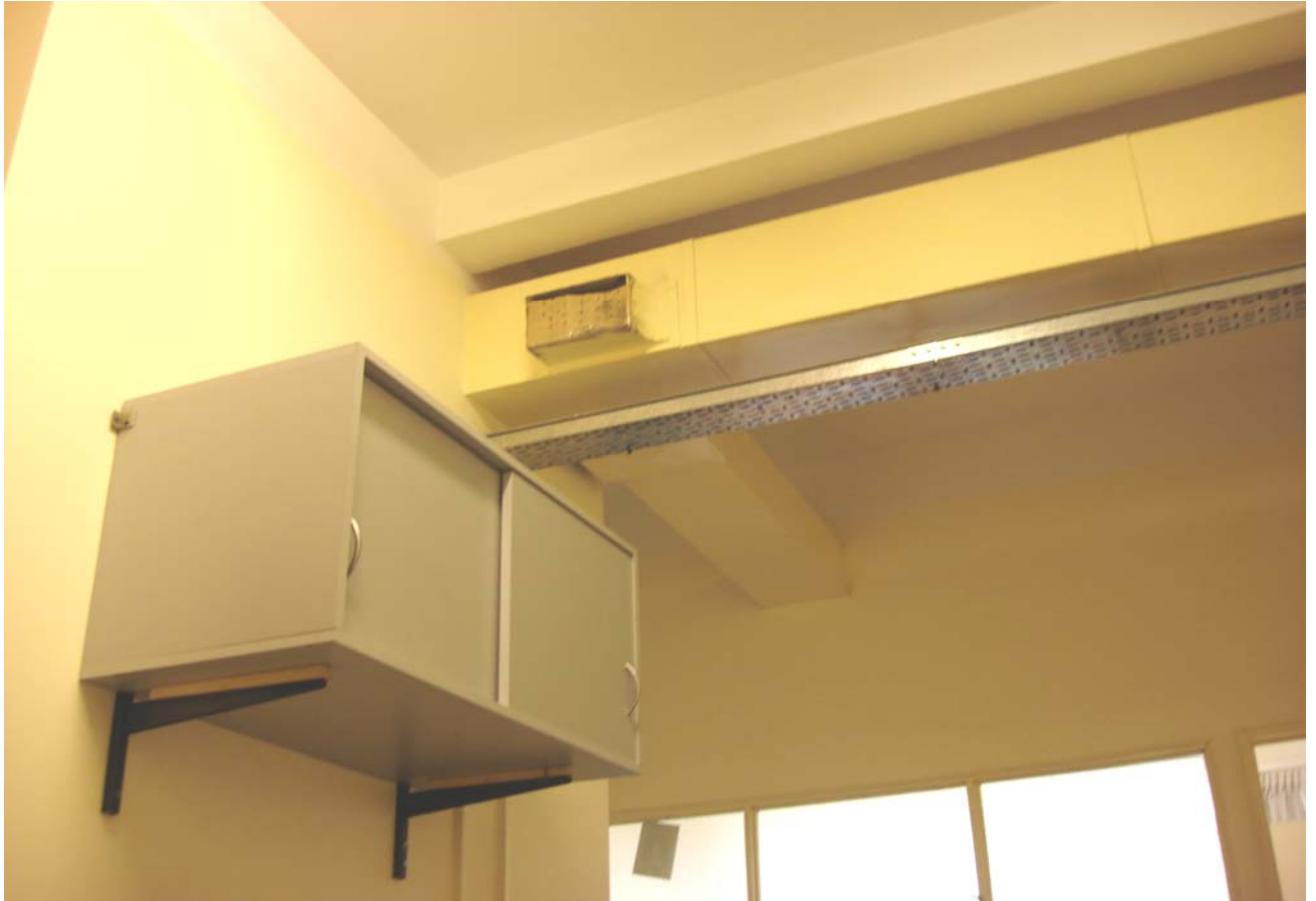
Foto N° 93: Observamos en la presente vista en una oficina del 1° piso en un ducto de AA vemos una grilla de salida de aire tapada, esto lo realiza el personal de las oficinas por no poder regular el caudal y la temperatura de salida del aire.
