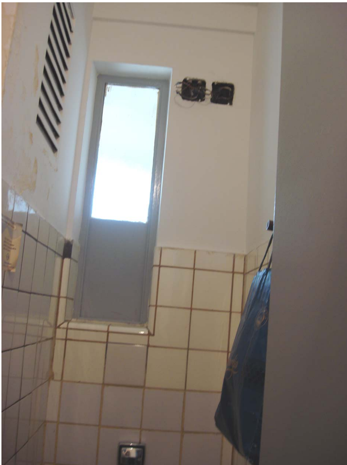
Foto N° 51: Observamos en la presente vista en un sanitario del 8º piso dos cajas de distribución de electricidad sin tapas y con los cables expuestos y encintados.
