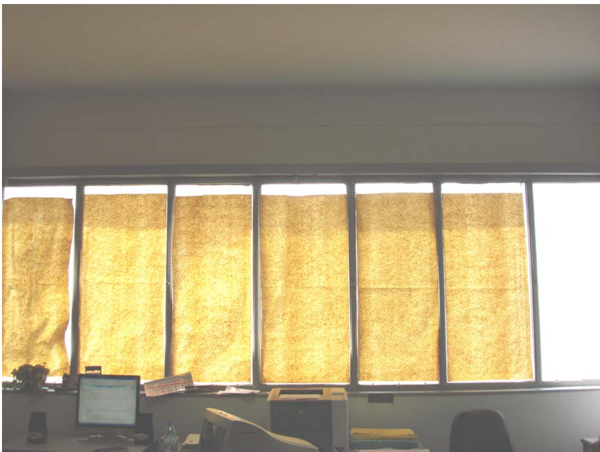
Foto N° 75: Observamos en la presente vista en una oficina del 7º piso, las ventanas tapadas con papeles por no haber en las mismas elementos para oscurecimiento.
