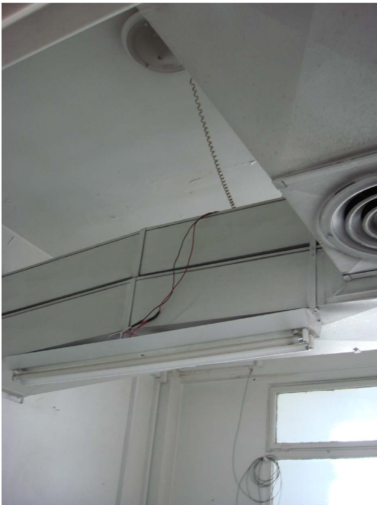
Foto N° 33: Observamos en la presente vista en una oficina del 9º piso un artefacto de iluminación con dos tubos fluorescentes fijados al ducto de AA el que presenta los cables de la conexión eléctrica expuestos y encintados.
