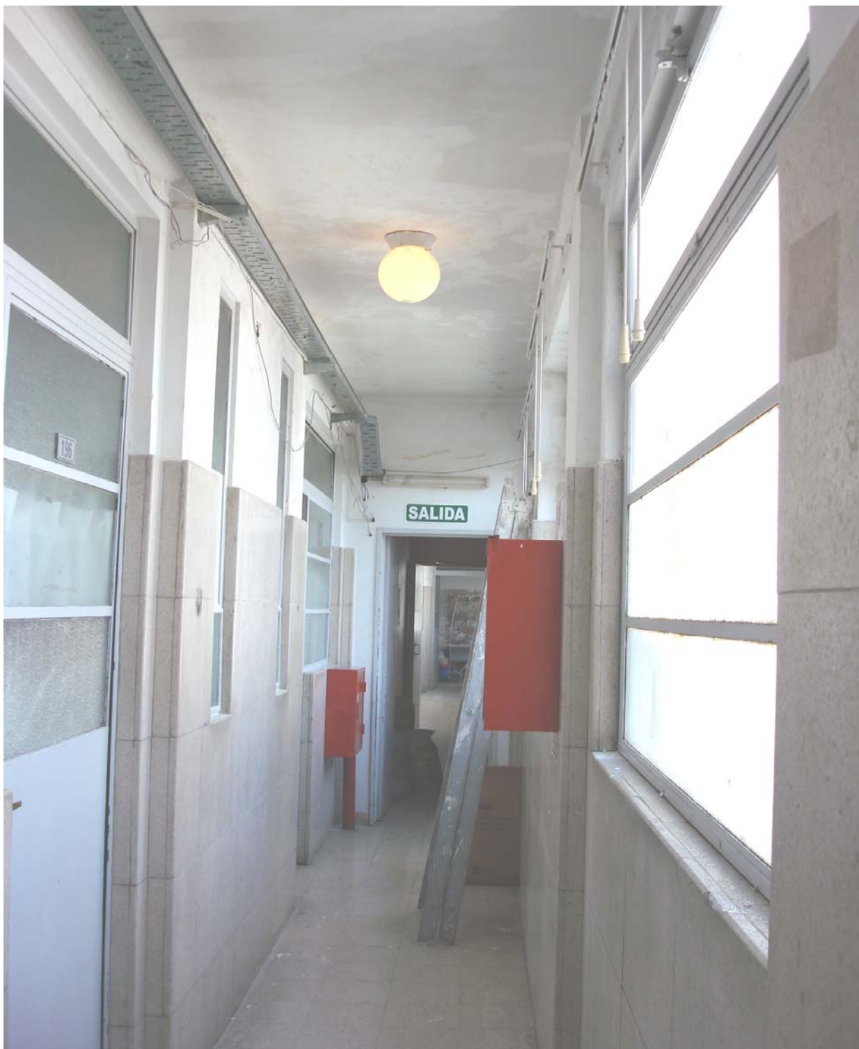
Foto N° 47: Observamos en la presente vista un pasillo del 9º piso donde se ven en el cielorraso rastros de humedad y cables de electricidad expuestos y encintados que cuelgan y pasan por orificios en la pared del fondo al palier de ascensores. En la pared de la derecha se ve una cabina con la manguera del sistema contra incendio y a la izquierda un matafuego con la carga vigente fijado a la pared sobre la chapa reglamentaria.
