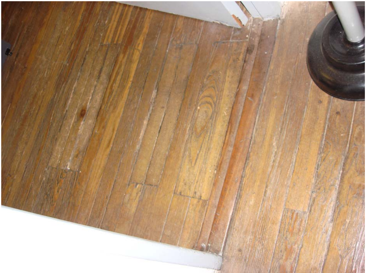
Foto N° 76: Observamos en la presente vista en la unión de dos oficinas del 7º piso el piso de madera de pinotea muy deteriorado.
