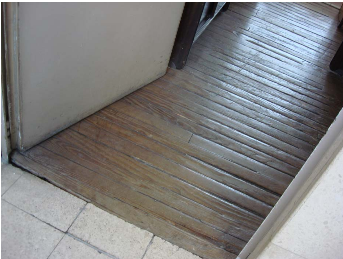
Foto N° 56: Observamos en la presente vista el solado de madera de pinotea en una oficina del 8° piso muy deteriorado, a la izquierda en la unión con los mosaicos del pasillo común se puede ver una separación y en algunos sectores estas tablillas al paso de la gente se hunde.
