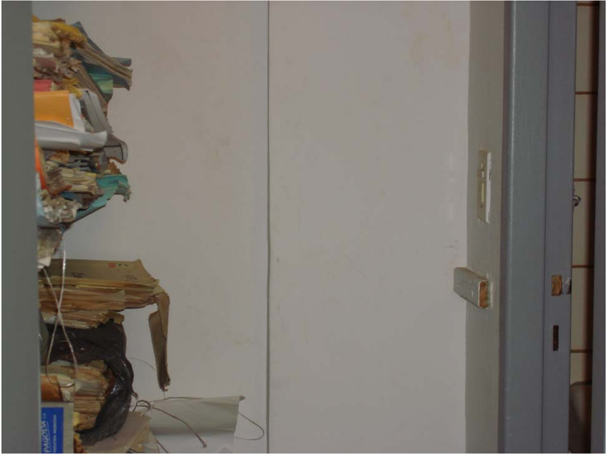
Foto Nº 73: Observamos en la presente vista de un baño del 7º piso donde la antecámara del mismo se usa como depósito de expedientes.
