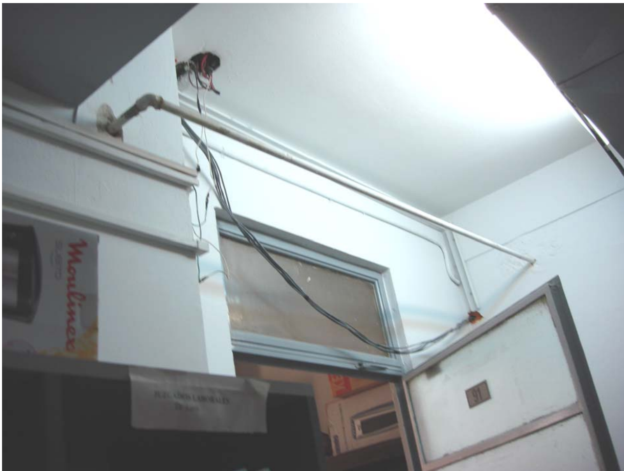
Foto N° 17: Observamos en la presente vista cables de electricidad expuestos que salen de una boca de electricidad en el cielorraso y cuelgan por sobre una puerta hacia una perforación en la pared.
