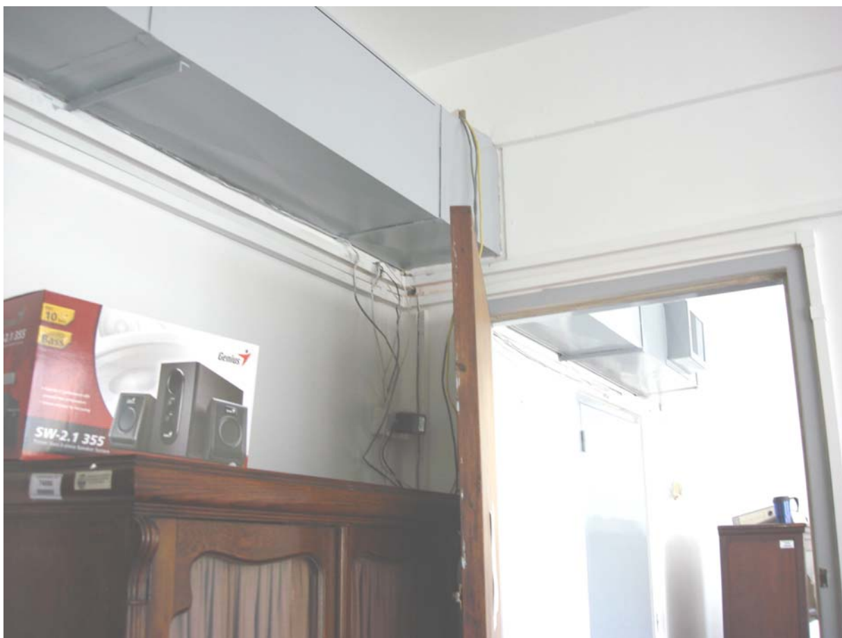
Foto N° 52: Observamos en la presente vista en una oficina del 8º piso cables de electricidad expuestos y encintados que cuelgan debajo de la tubería de AA, algunos salen de un cablecanal y pasan a la otra oficina.
