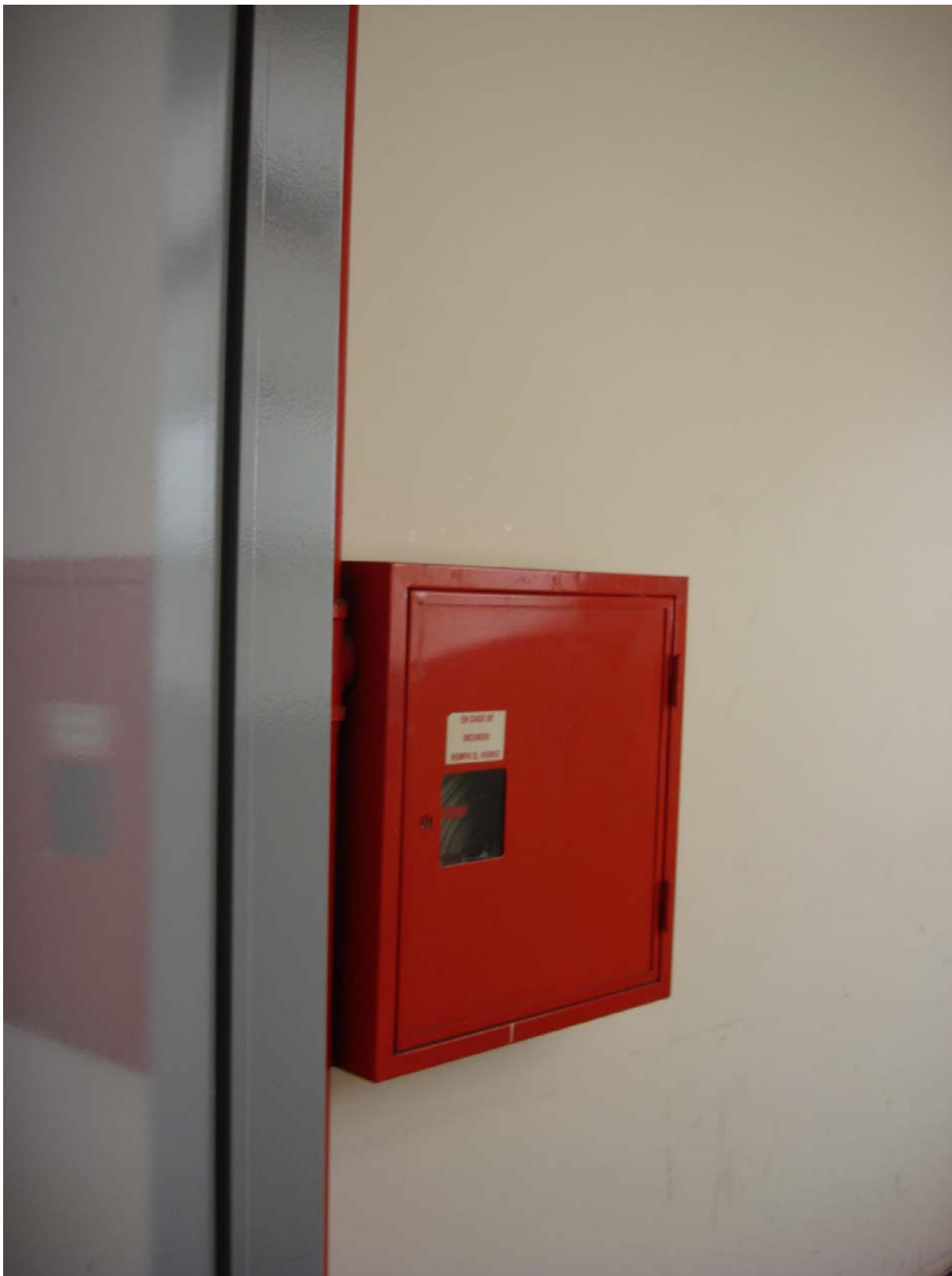
Foto N° 69: Observamos en la presente vista una cabina del sistema contra incendio con la manguera, lanza y llave de paso. Es de notar que este sistema no funciona pero estos equipos están colocados en todos los pisos y en la azotea.
