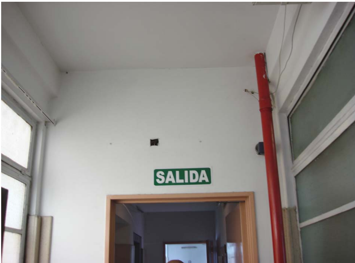
Foto N° 61: Observamos en la presente vista en el pasillo exterior del 8° piso en la parte superior a la derecha cables de electricidad expuestos que cuelgan y pasan por detrás de un caño del sistema contra incendio y penetran en la pared por un orificio y pasan para el palier de salida y sobre la puerta del frente el cartel de salida y encima una caja de derivación eléctrica sin tapa y con los cables de electricidad expuestos.
