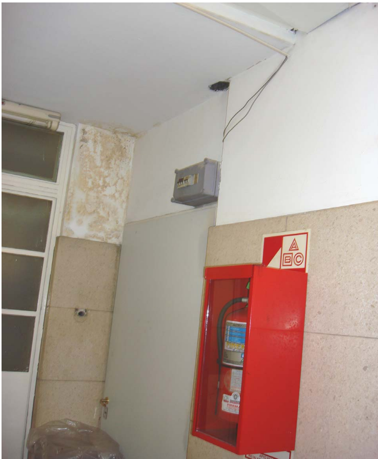
Foto N° 60: Observamos en la presente vista en una oficina del 8° piso sobre todo un paño de la pared de la izquierda rastros de humedad, mas a la izquierda un artefacto con un tubo fluorescente de la luz de emergencia, en la pared de la derecha un tablero de electricidad seccional del cual salen dos cables de electricidad expuestos los que penetran en un cablecanal medio despegado del cielorraso y mas abajo fijado sobre una chapa reglamentaria un matafuego del tipo ABC con la carga vigente.
