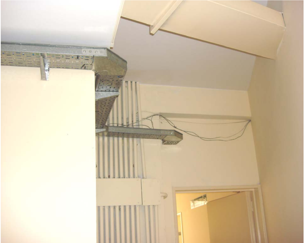
Foto N° 91: Observamos en la presente vista en un sector del 4º piso cables de electricidad expuestos que salen de una bandeja porta cables y penetra por un orificio en la pared hacia otro local.
