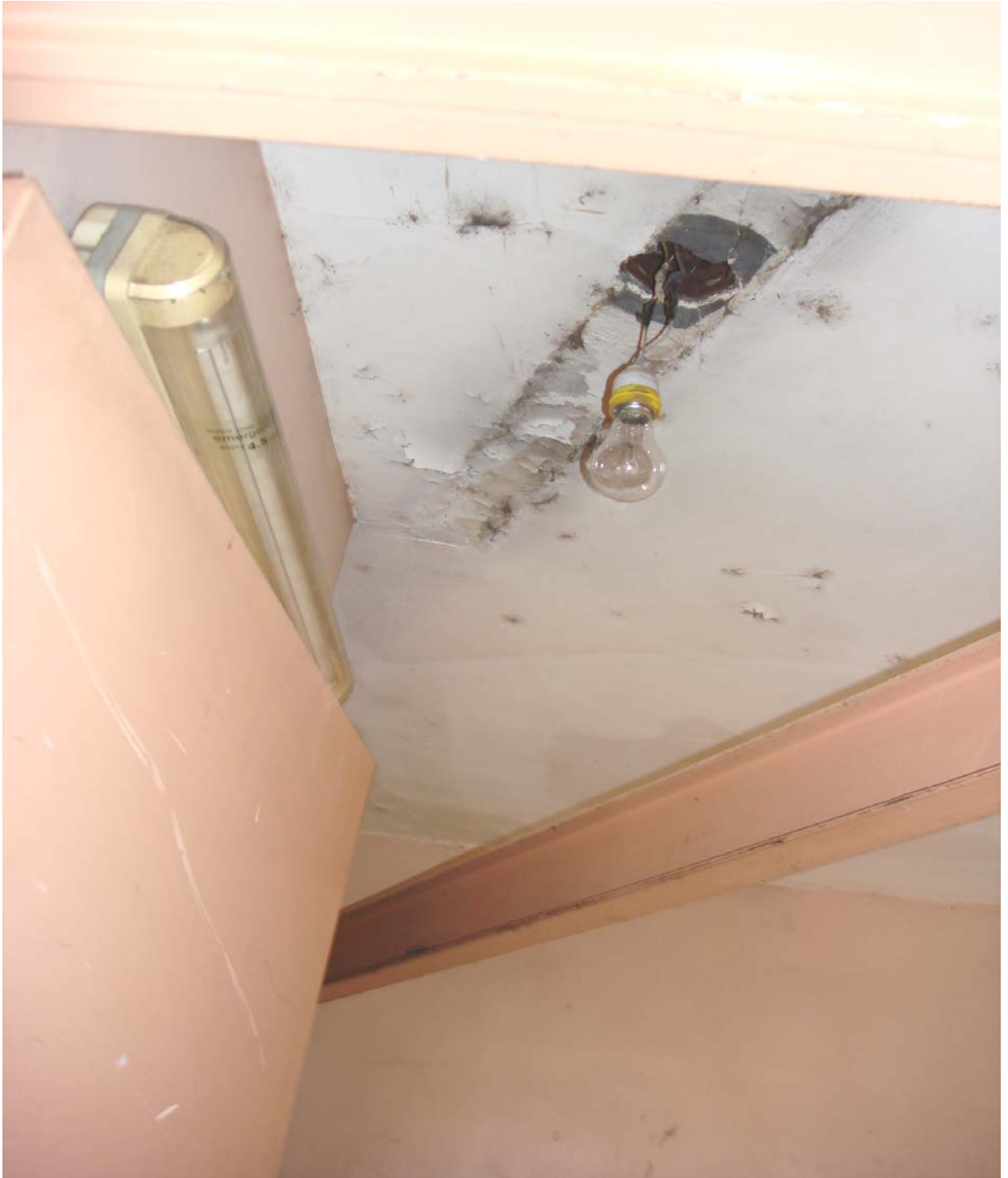
Foto N° 13: Observamos en la presente vista en un sector de “ mantenimiento ” una boca de un centro de electricidad que presenta los cables expuestos y encintados los que conectan un portalámpara, es de notar que en este cielorraso hay rastros de humedad , a la izquierda sobre la pared hay un artefacto con un tubo fluorescente del sistema de luz de emergencia.
