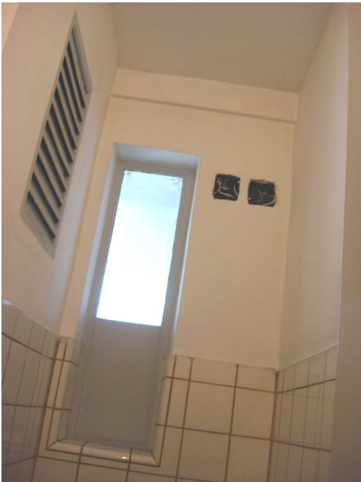
Foto N° 55: Observamos en la presente vista en un sanitario del 8° piso (similar al de la foto N° 51) dos cajas de distribución de electricidad sin tapas y con los cables expuestos y encintados.
