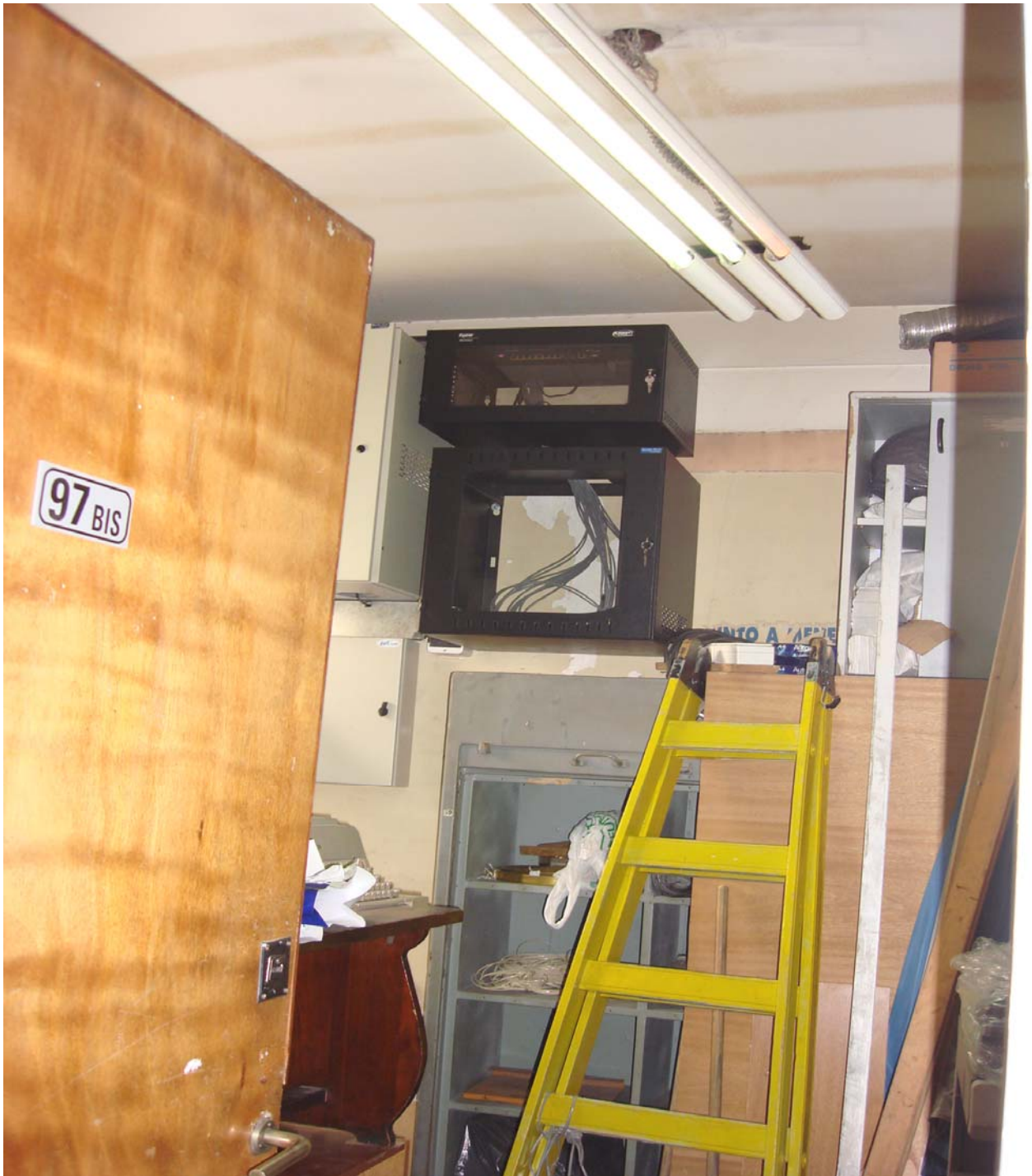
Foto N° 30: vemos en la presente vista en una oficina del 9º piso de “mantenimiento” varios elementos de oficina algunos en uso otros depositados, un rack de sistemas, una escalera y en el cielorraso un artefacto de iluminación con tubos fluorescentes y el centro de conexión sin tapa y con los cables de electricidad que salen sin protección.
