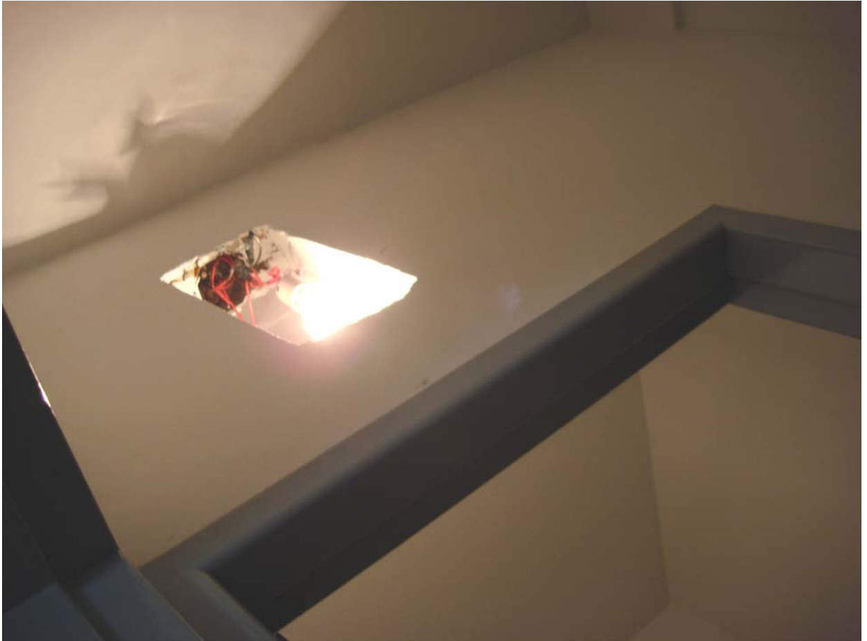
Foto N° 18: Observamos en la presente vista cables de electricidad expuestos que salen de una boca dentro de una pared sobre la puerta que divide un sanitario con el ante baño del 9° piso.
