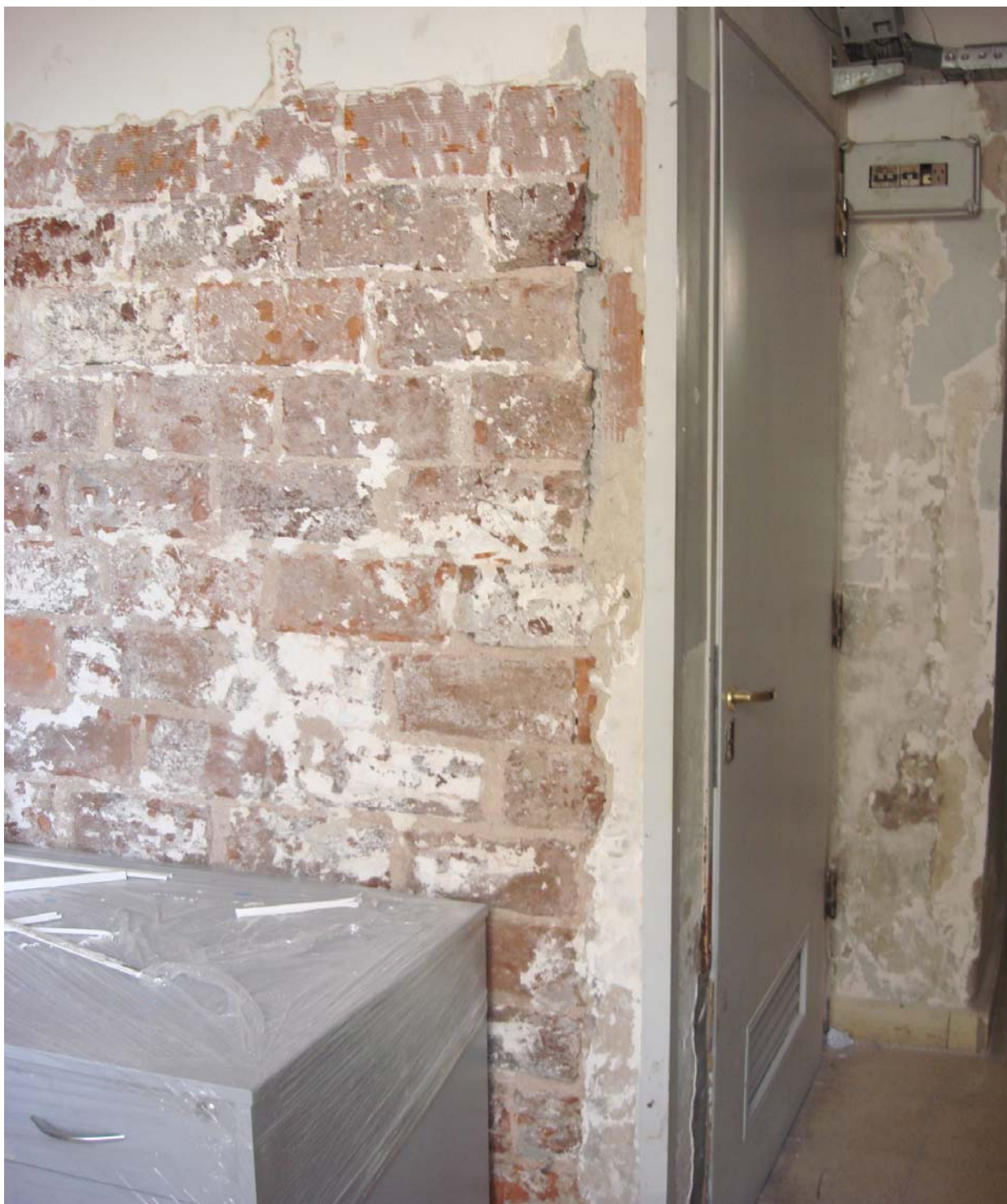
Foto N° 32: Observamos en la presente vista de una oficina del 9º piso donde observamos las paredes sin revoque con huellas de humedad y el marco de la puerta con un importante grado de corrosión al punto que ya le falta una parte del marco.
