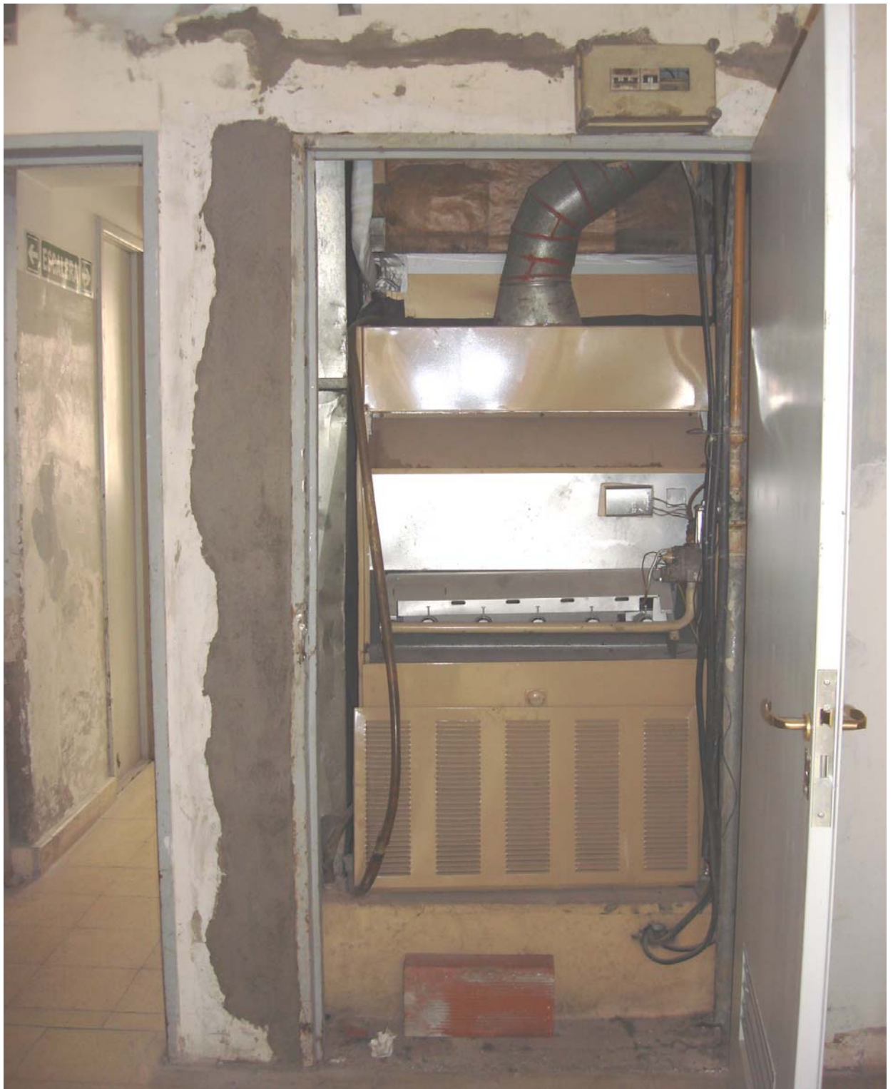
Foto Nº 29: vemos en la presente vista un equipo de aire acondicionado “reparado” y en funcionamiento donde observamos que presenta cables de electricidad expuestos y las paredes con los revoques a medio terminar, en la pared del pasillo de la izquierda hay rastros de humedad .
