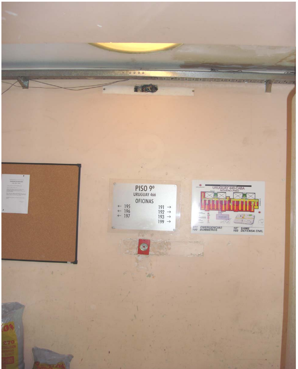
Foto N° 39: Observamos en la presente vista del palier del 9º piso frente a los ascensores, fijados en la pared, el plano de evacuación, un pulsador de la alarma contra incendio y en la parte alta un centro de electricidad de baja tensión con los cables expuestos donde se fija normalmente un tubo fluorescente de la iluminación de emergencia que no esta colocado y sobre esto una bandeja de la que cuelgan varios cables expuestos .
