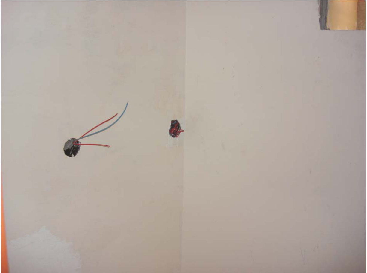
Foto N° 7: Observamos en la presente vista del salón de usos múltiples, cables de electricidad expuestos (sin conectar) y detalles de albañilería sin terminaciones.
