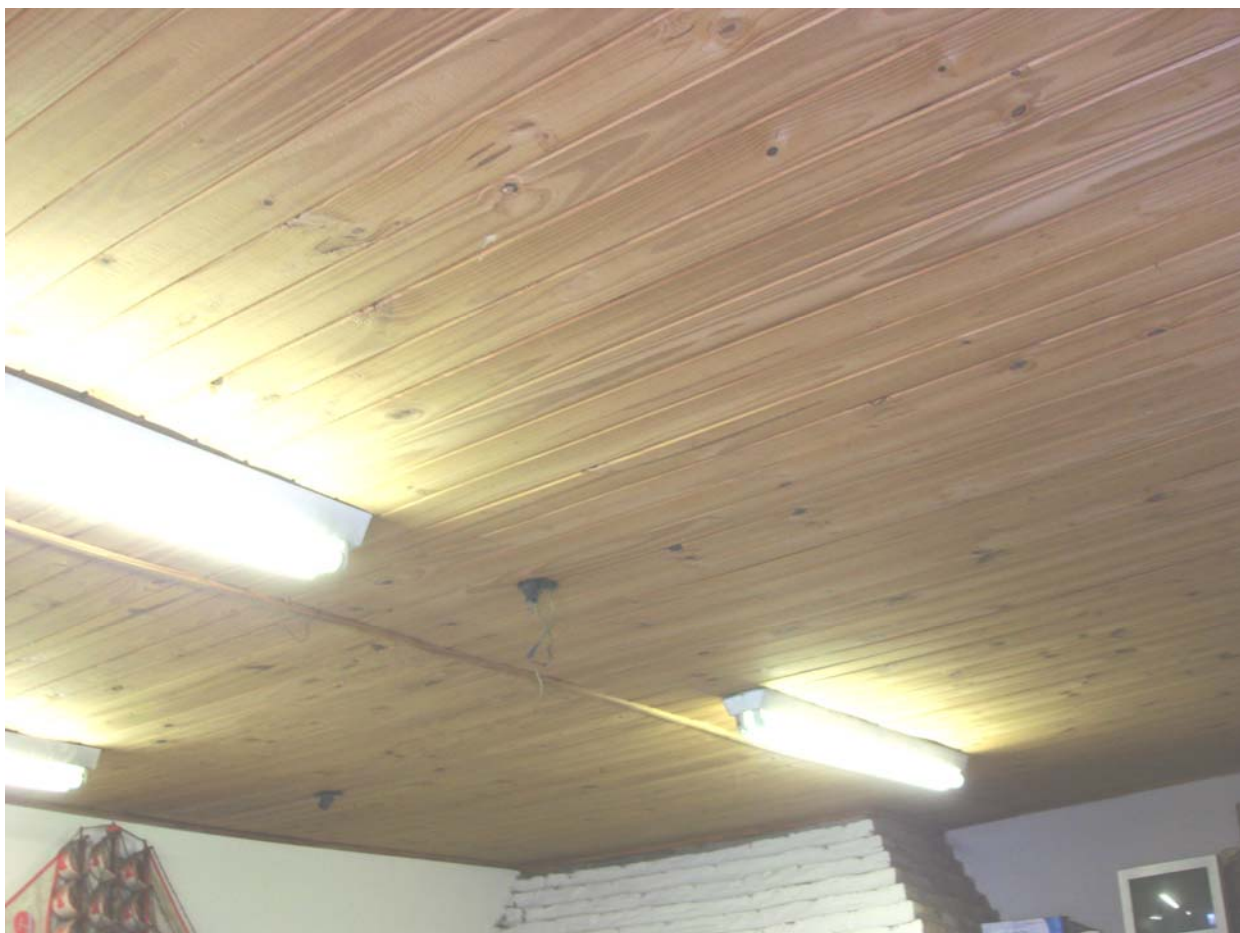
Foto N° 11: Observamos en la presente vista en el sector de mantenimiento un centro de electricidad con los cables expuestos .
