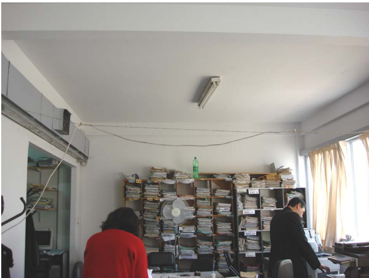
Foto N° 59: Observamos en la presente vista en una oficina del 8° piso cables de sistema que cruzan colgados de otro cable de electricidad de una pared a otra y a la izquierda en el ducto de AA una rejilla de salida de aire tapada al no poder regular el flujo ni la temperatura en la salida del AA. Es de notar la cantidad de expedientes que hay en todo el organismo.
