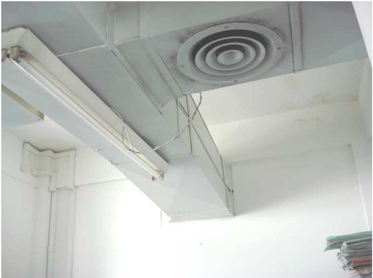
Foto N° 43: Observamos en la presente vista en el cielorraso de una oficina del 9º piso rastros de humedad por filtraciones, tuberías de AA que pasa a 40 cm del techo y de la que cuelgan cables de electricidad expuestos y encintados y dos de estos conductores alimentan a un artefacto de iluminación para dos tubos fluorescentes (con uno solo colocado) fijado en la parte inferior del mismo.
