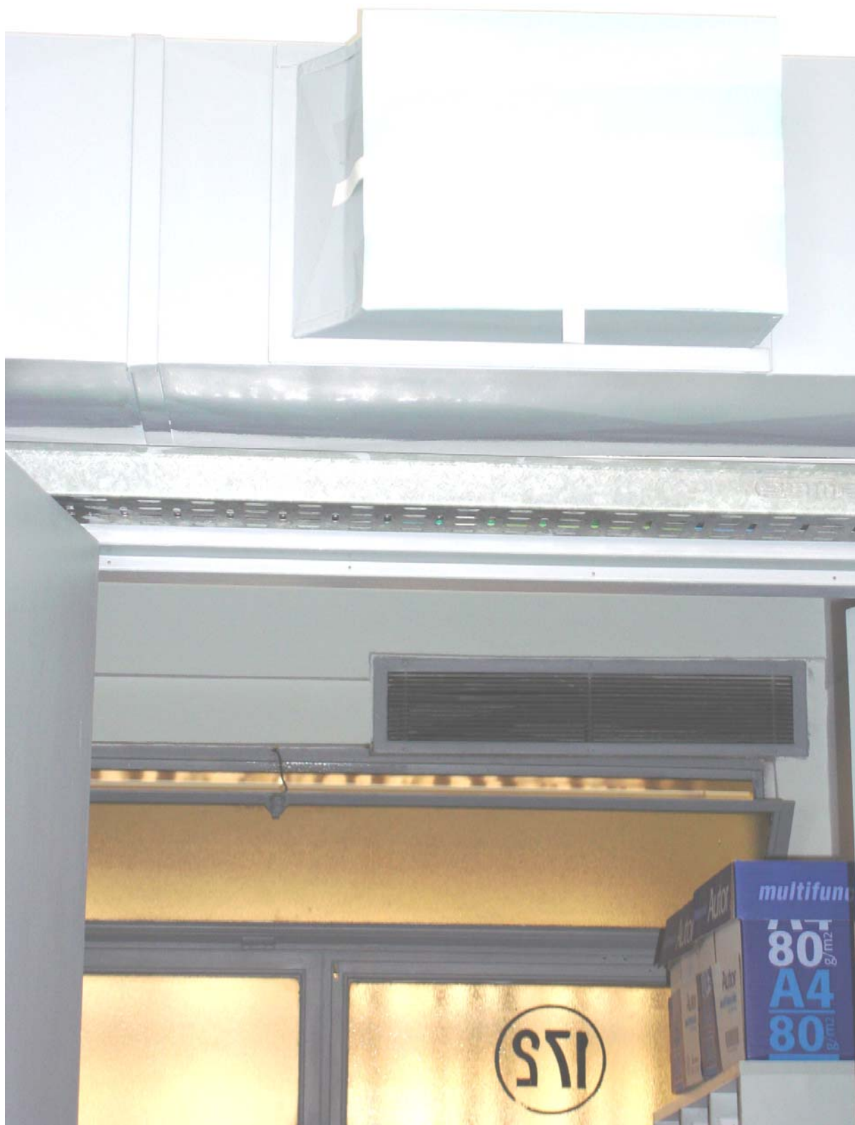
Foto N° 74: Observamos en la presente vista de una oficina del 7º piso en la parte superior de un ducto de AA una grilla tapada por no poderse regular en la salida, el caudal y la temperatura del aire.
