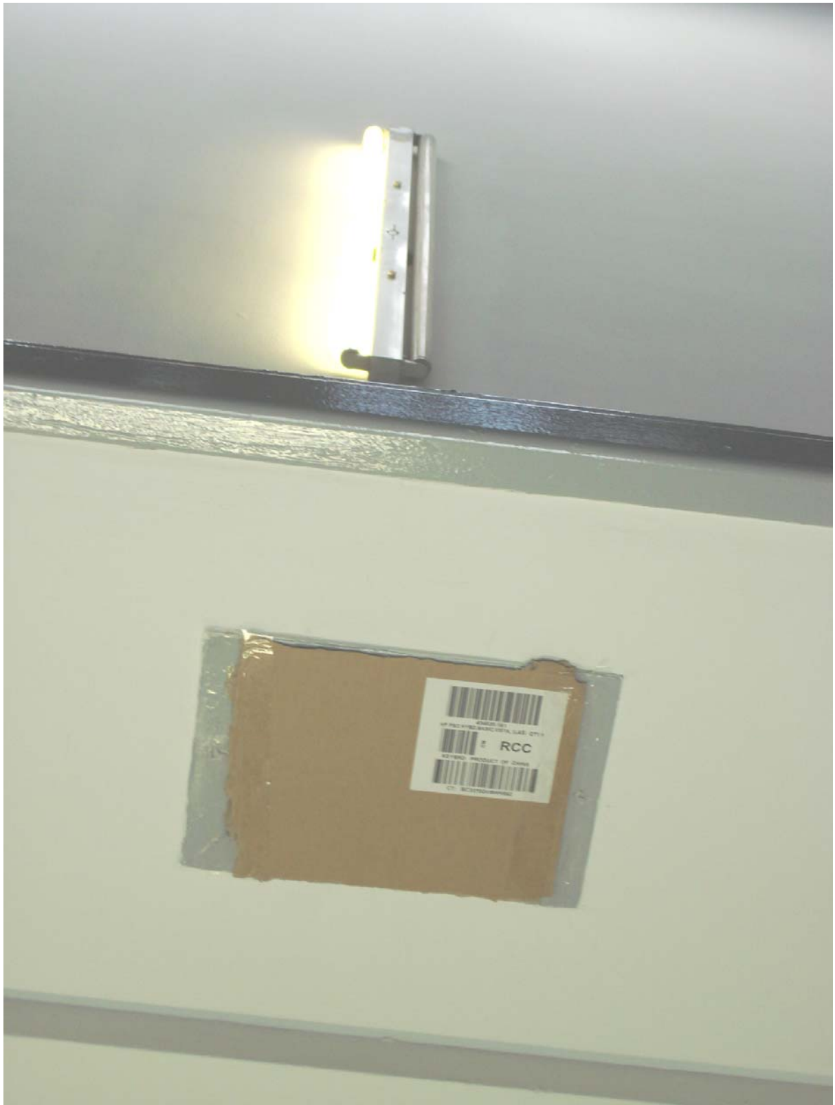
Foto N° 82: Observamos en la presente vista en una oficina del 6° piso una grilla de salida de aire de un ducto de AA, como hemos visto en otros ejemplos se tapan por que no se puede regular en la salida el caudal y la temperatura del aire.
