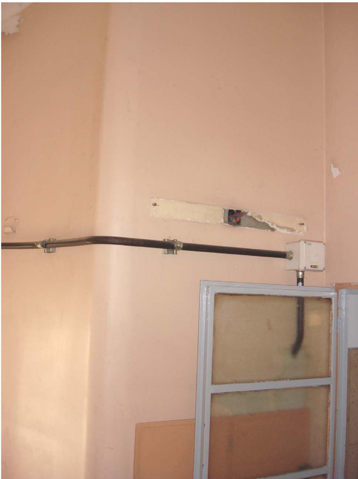
Foto N° 16: Observamos en la presente vista en el palier del 9° piso una boca del sistema de luz de emergencia de electricidad con los cables expuestos (baja tensión).
