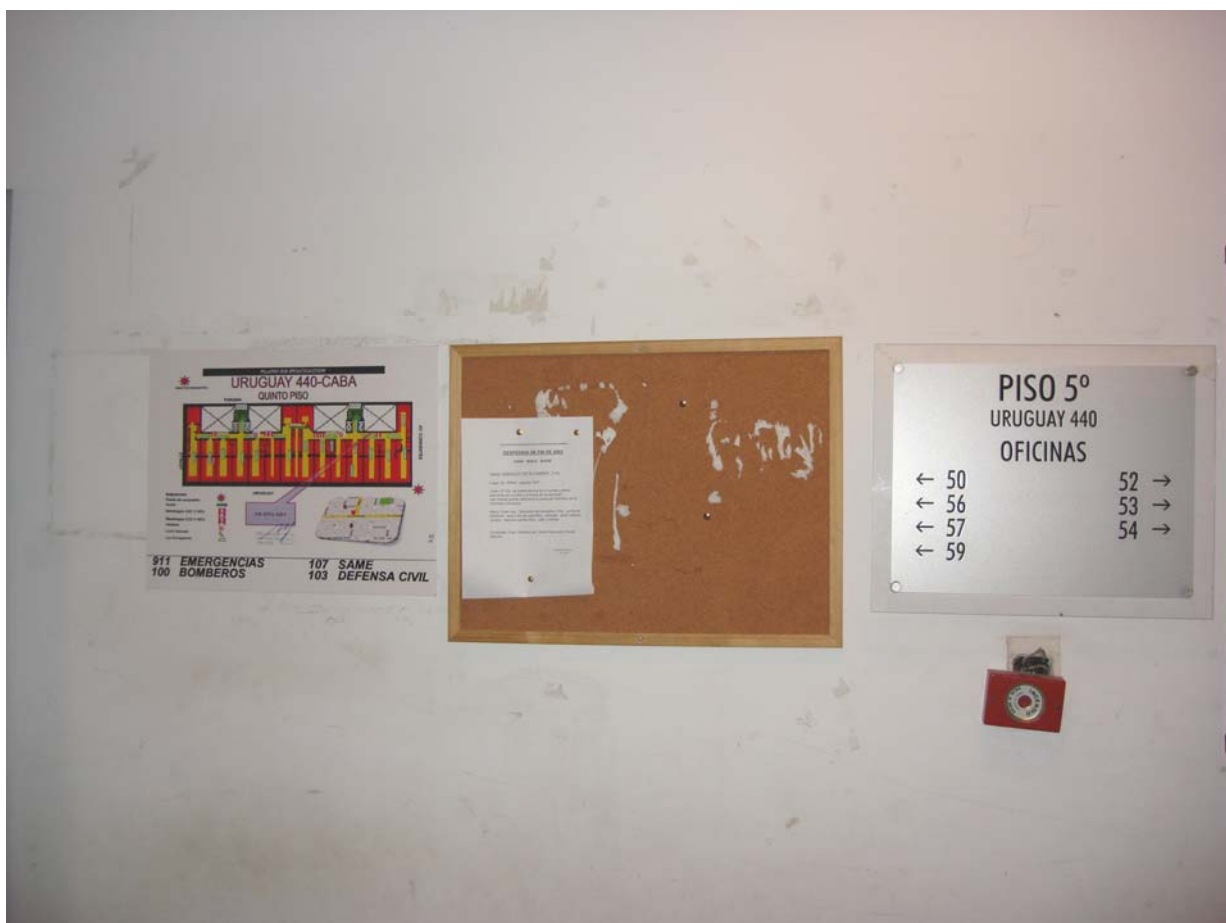
Foto N° 86: Observamos en la presente vista en una pared del palier del 5° piso el plano de evacuación, un cuadro que orienta hacia donde están las diferentes oficinas, un panel para colocar comunicaciones y un pulsador del sistema de alarma contra incendio, este último se encuentra medio descolgado mostrando los cables de electricidad expuestos (baja tensión).
