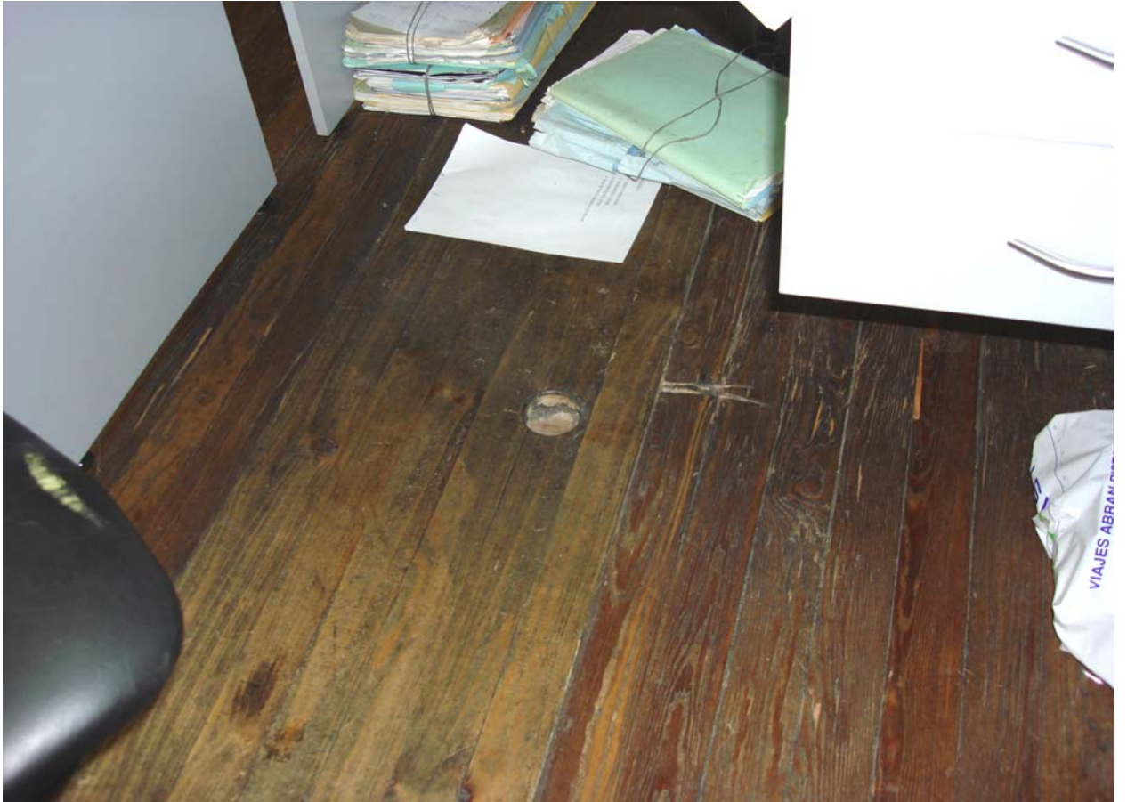
Foto N° 66: Observamos en la presente vista el piso de madera de pinotea de una oficina del 7° piso muy deteriorado.
