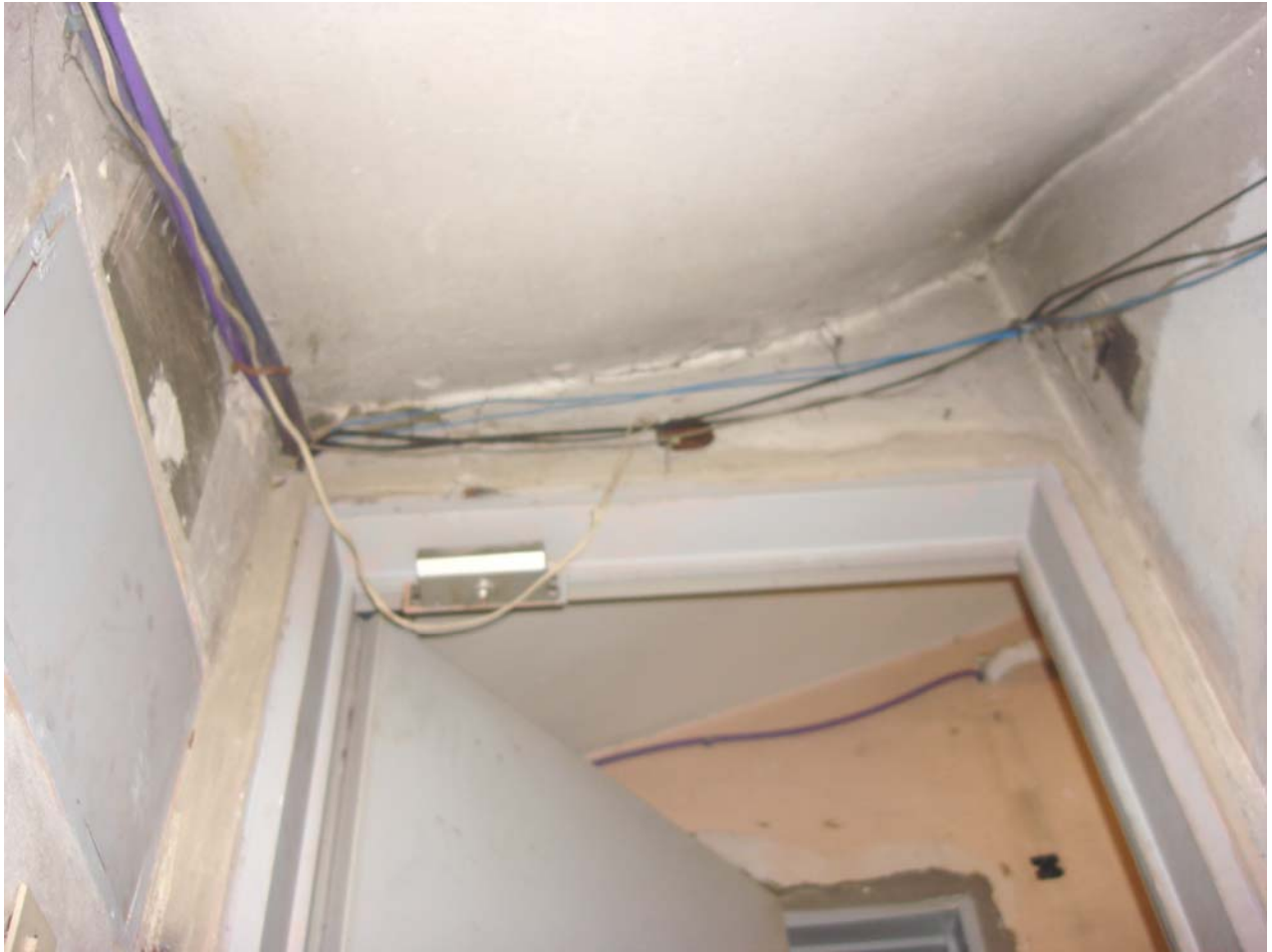
Foto N° 97: Observamos en la presente vista de un sector del sótano donde se pueden ver cajas de derivación eléctrica sin tapas, cables de electricidad expuestos que cuelgan sobre el marco de la puerta y todas las paredes revocadas y sin las terminaciones de pintura.
