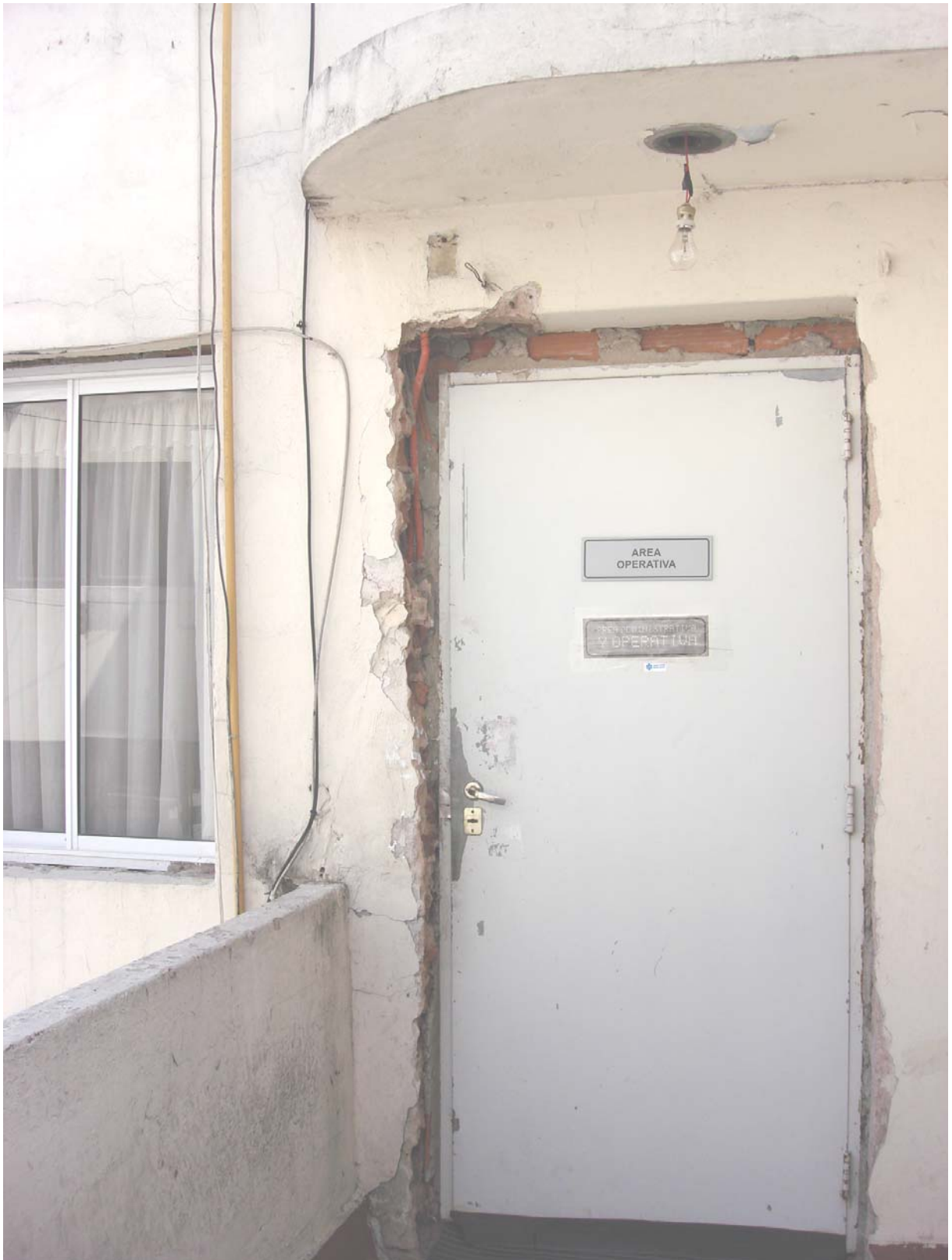
Foto N° 6: Observamos en la presente vista la puerta de acceso al salón de usos múltiples en la azotea que presenta después de 1 año y siete meses el mismo aspecto de la foto N° 19 del informe anterior, detalles en las paredes sin revocar y los mismos cables de electricidad expuestos.
