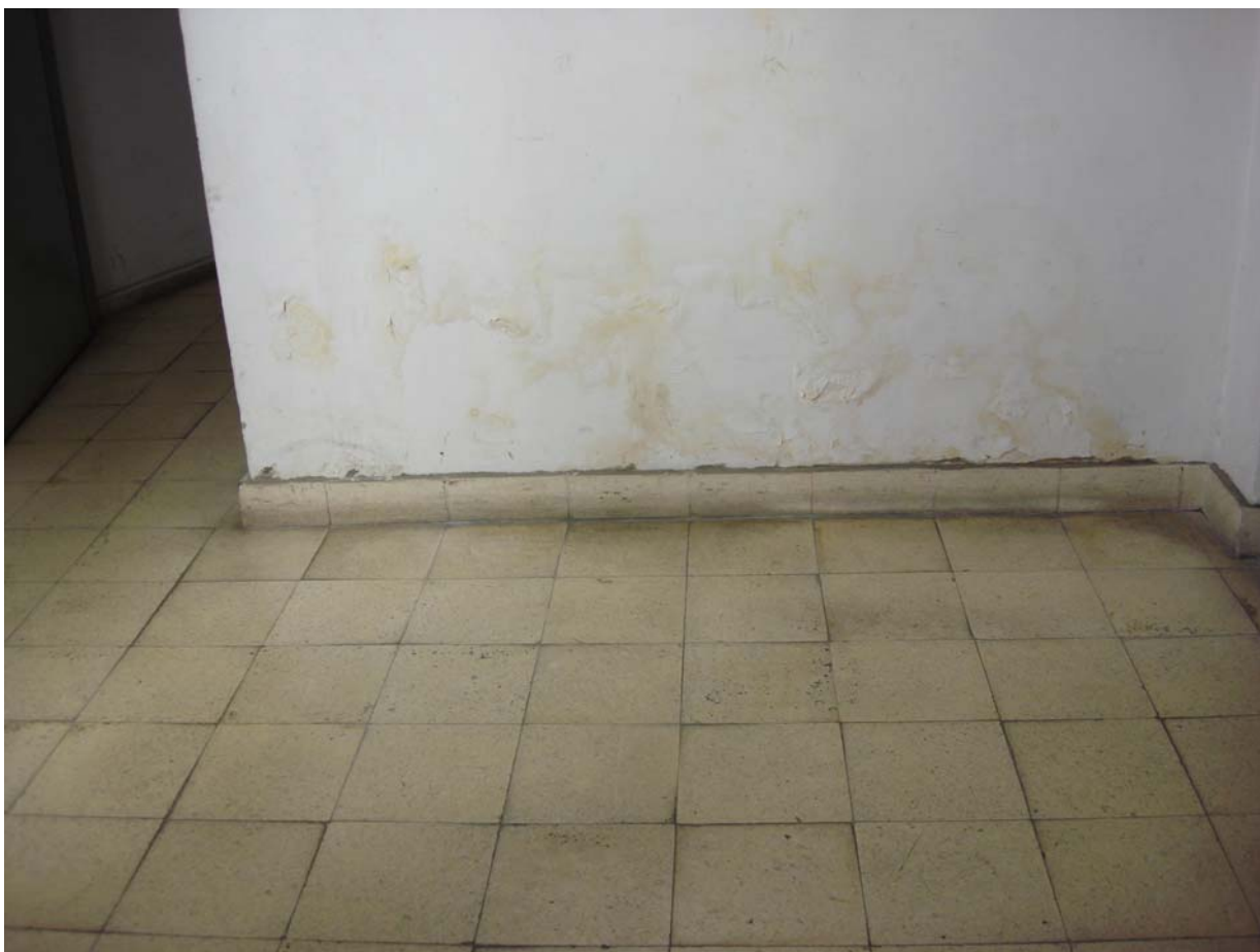
Foto N° 88: Observamos en la presente vista del pasillo general del 5º piso marcas de humedad en una pared la que presenta el revoque muy deteriorado.
