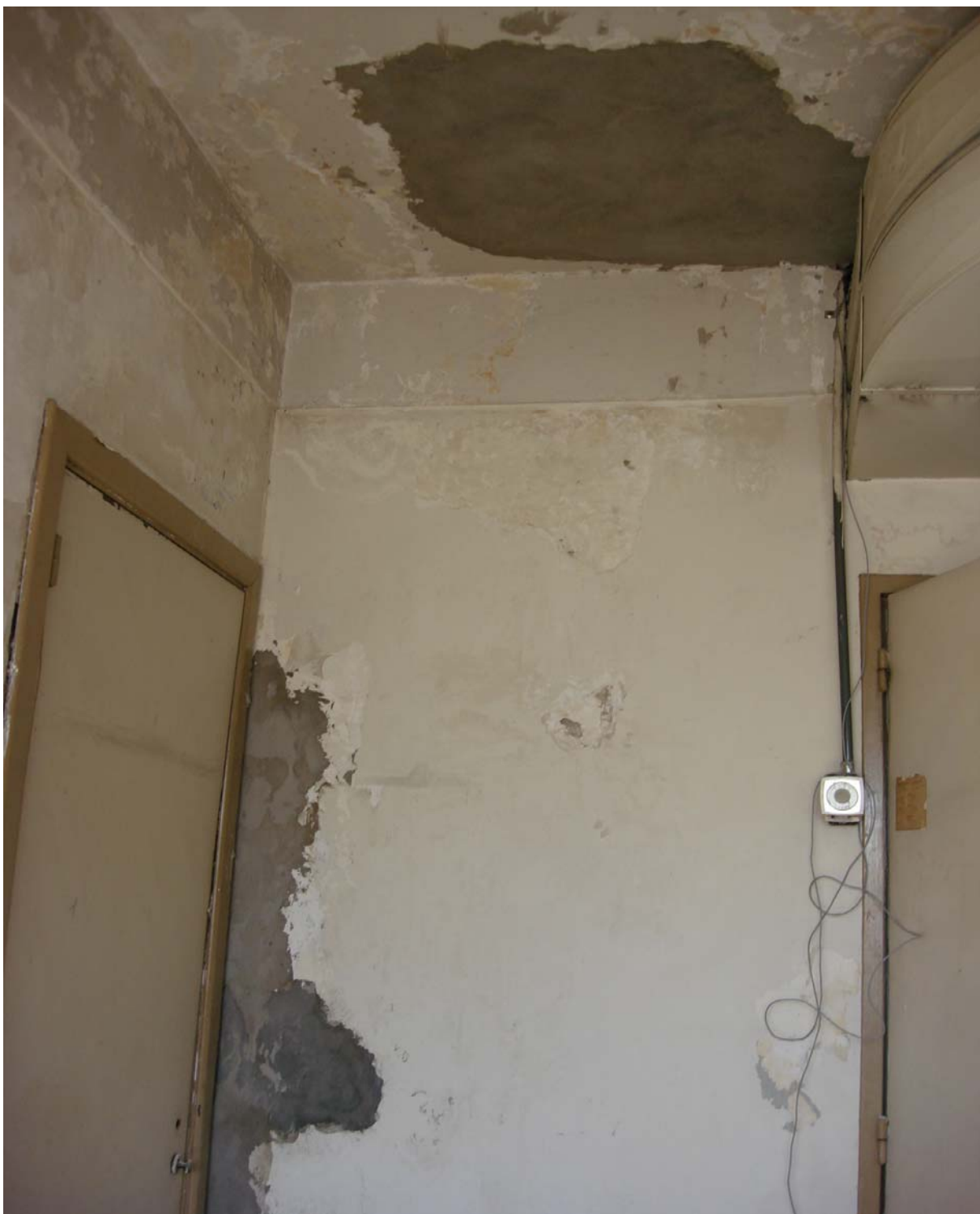
Foto N° 34: Observamos en la presente vista en una oficina del 9º piso las paredes deterioradas por efecto de la humedad y arregladas a medias y la presencia de cables de electricidad expuestos.
