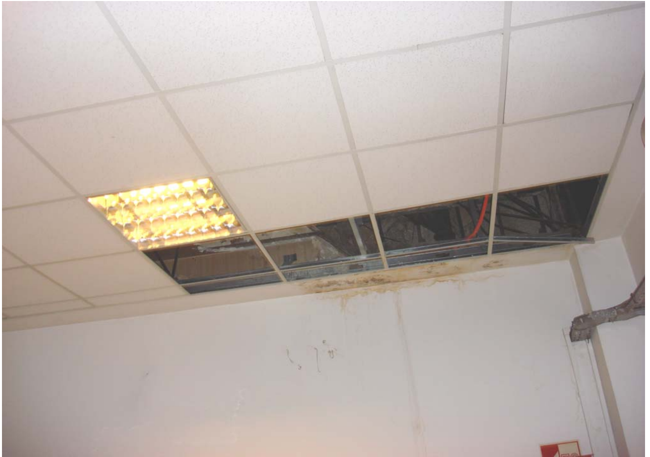
Foto N° 99: Observamos en la presente vista en un sector de planta baja el cielorraso abierto sin varios paños del revestimiento, dañados por efectos de las filtraciones de agua.
