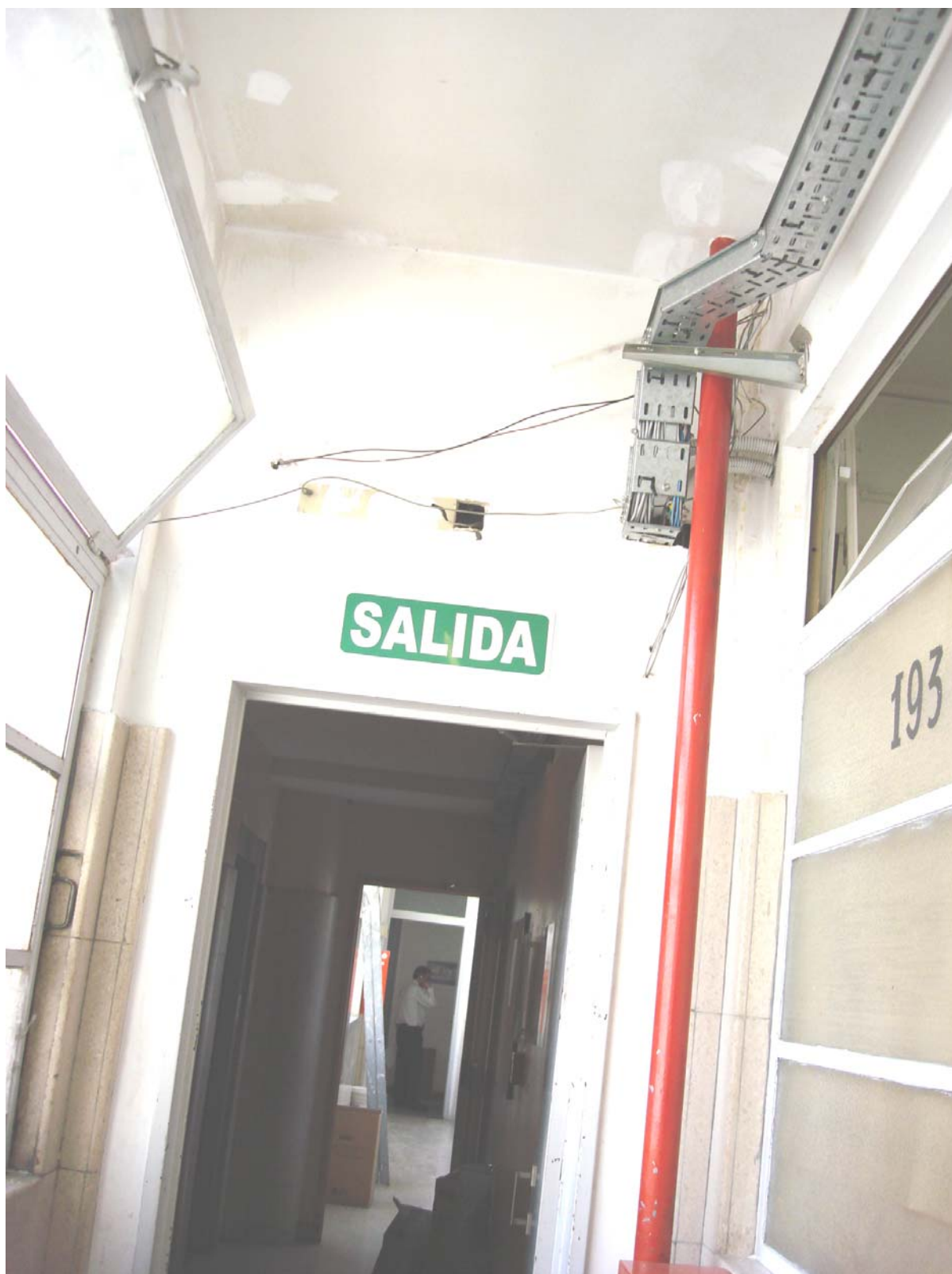
Foto N° 36: Observamos en la presente vista el pasillo que conduce a los ascensores del 9° piso con las paredes deterioradas por la humedad y cables de electricidad expuestos que salen de una bandeja y pasan al palier de los ascensores por un orificio en la pared sobre el marco de la puerta y por una caja de derivación eléctrica sin tapa.
