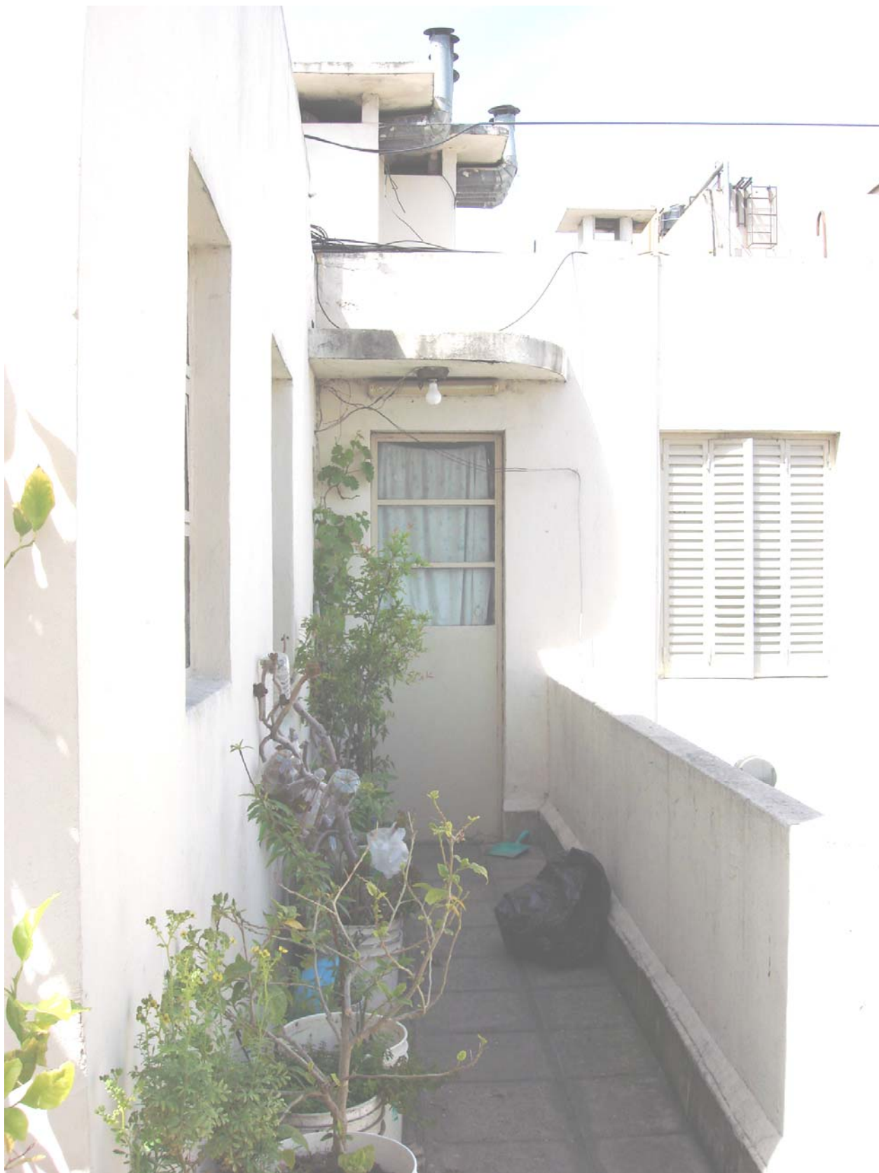
Foto N° 40: Observamos en la presente vista del 9° piso un pasillo de acceso a la vivienda del sereno y sobre la puerta varios cables de electricidad expuestos y encintados que cuelgan y bajan por el patio de la derecha.
