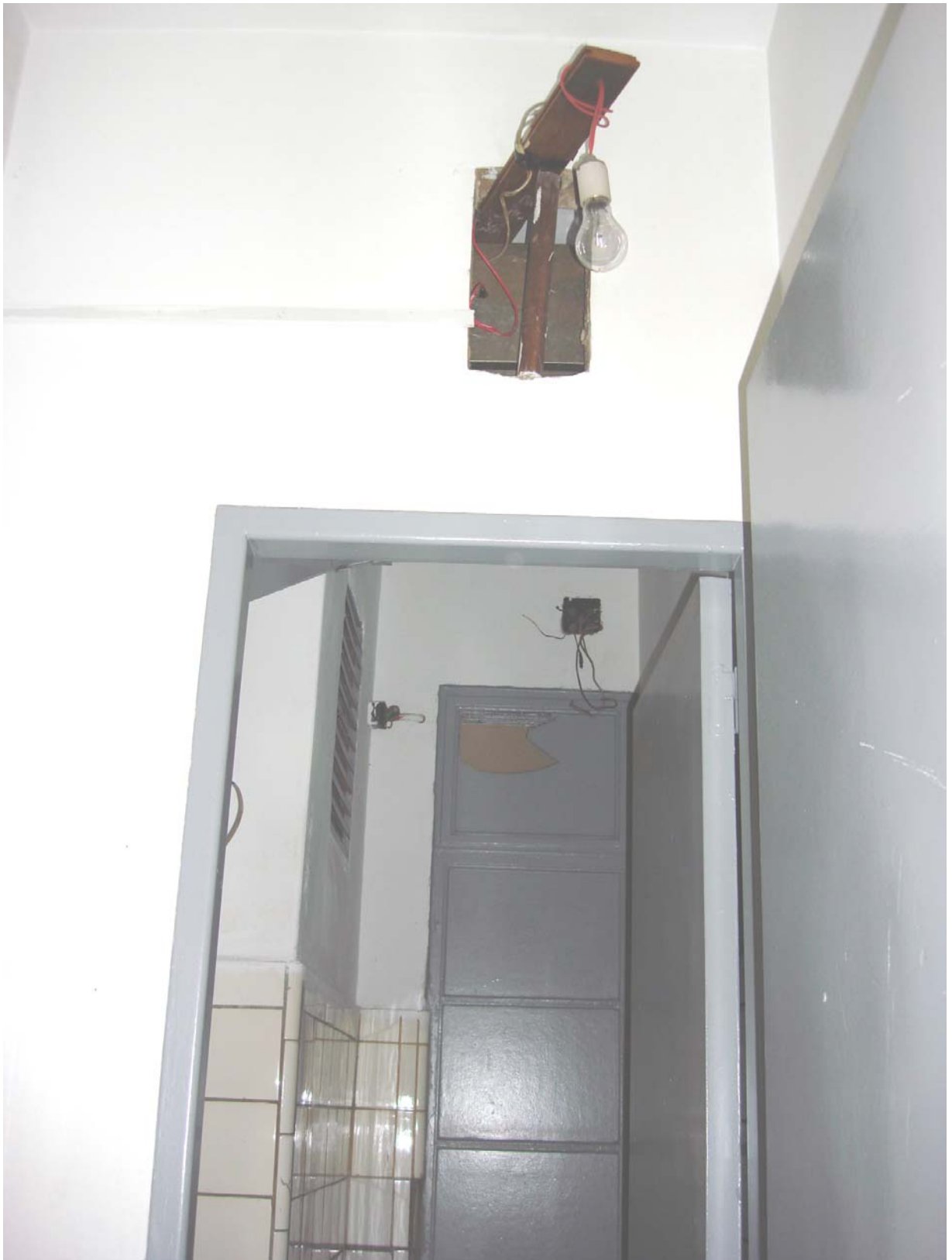
Foto N° 23: Observamos en la presente vista en un baño del 9º piso sobre una puerta un portalámpara montado sobre una madera con los cables de electricidad expuestos y atrás dos bocas de las cuales también salen cables de electricidad expuestos.
