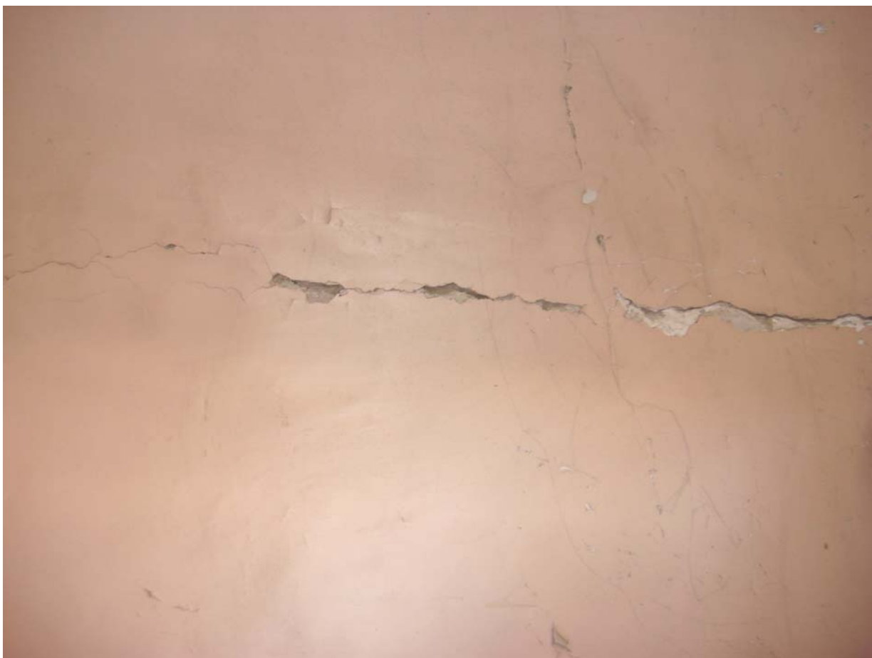
Foto N° 14: Observamos en la presente vista sobre el descanso de la escalera del 9° piso una rajadura en el cielorraso que estaba denunciada en el informe anterior 5.07.09 (ver foto N° 20).
