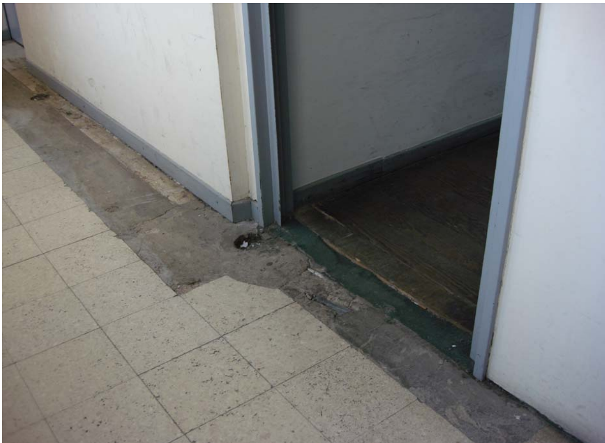
Foto N° 70: Observamos en la presente vista el solado frente a una oficina del 7° piso, la que anteriormente estaría alfombrada, con mosaico parte revocada y todavía queda una tira de alfombra cómo umbral (o solia).
