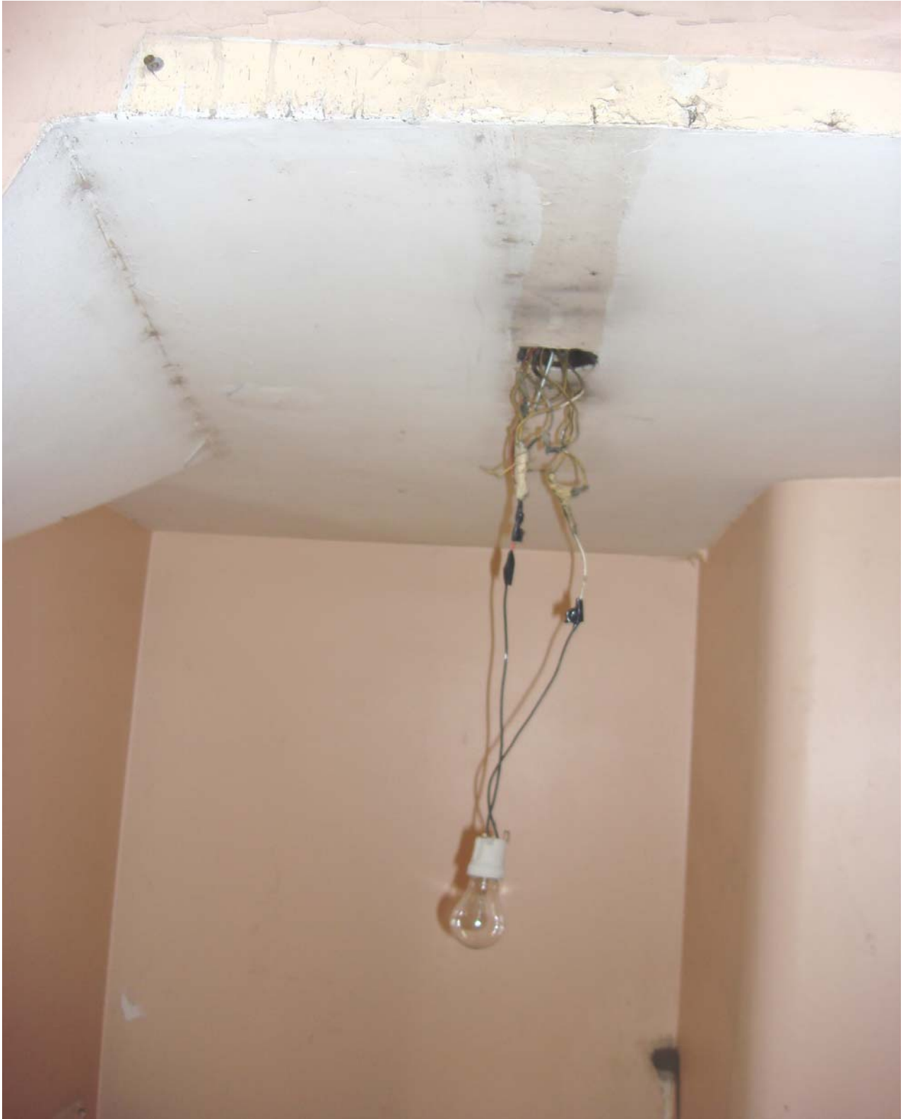
Foto N° 15: Observamos en la presente vista en un descanso del 9° piso un portalámpara conectado en cables de electricidad expuestos y encintados que salen de una boca de electricidad y cuelgan hacia abajo 90 cm, en la pared del fondo a la derecha hay una boca de electricidad sin tapa de la que salen cables de electricidad expuestos .
