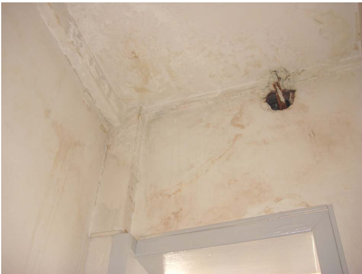
Foto N° 44: Observamos en la presente vista del cielorraso de un sector del 9º piso rastros de humedad generalizado en el techo y las paredes y en la parte superior una abertura o caja de inspección eléctrica.
