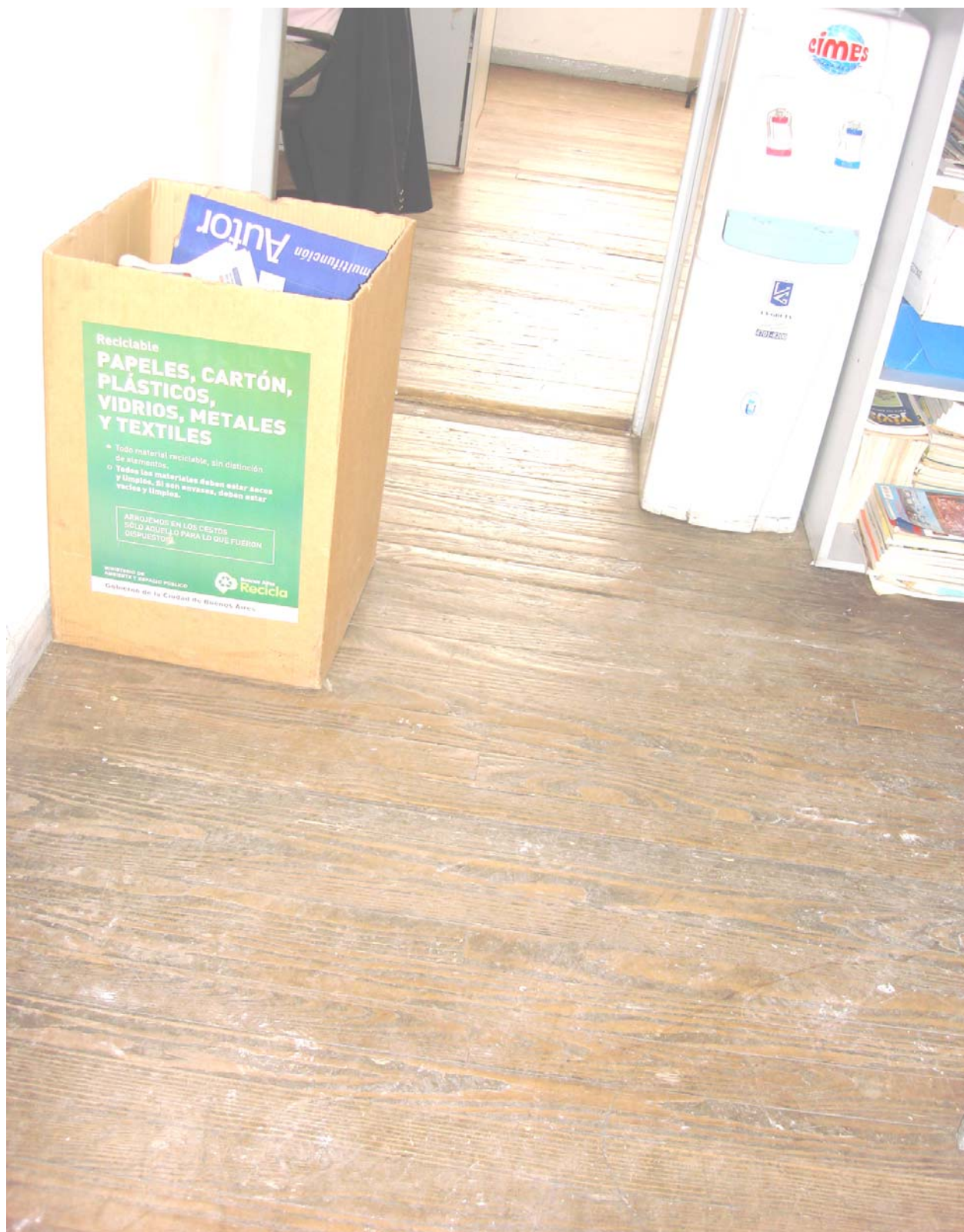
Foto Nº 46: Observamos en la presente vista el solado de madera de pinotea de un local del 9º piso, muy deteriorado.
