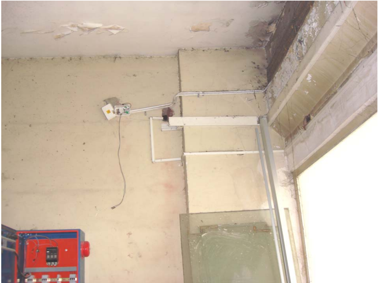
Foto N° 103: Observamos en la presente vista del local de planta baja donde esta el equipo de bombeo contra incendio, atrás a la izquierda vemos el tablero de electricidad que opera estos equipos sin la contratapa reglamentaria y con cables de electricidad expuestos y en la parte superior cables expuestos los que salen de una llave de corte descolgada de su lugar de origen y en el frente rastros de humedad.
