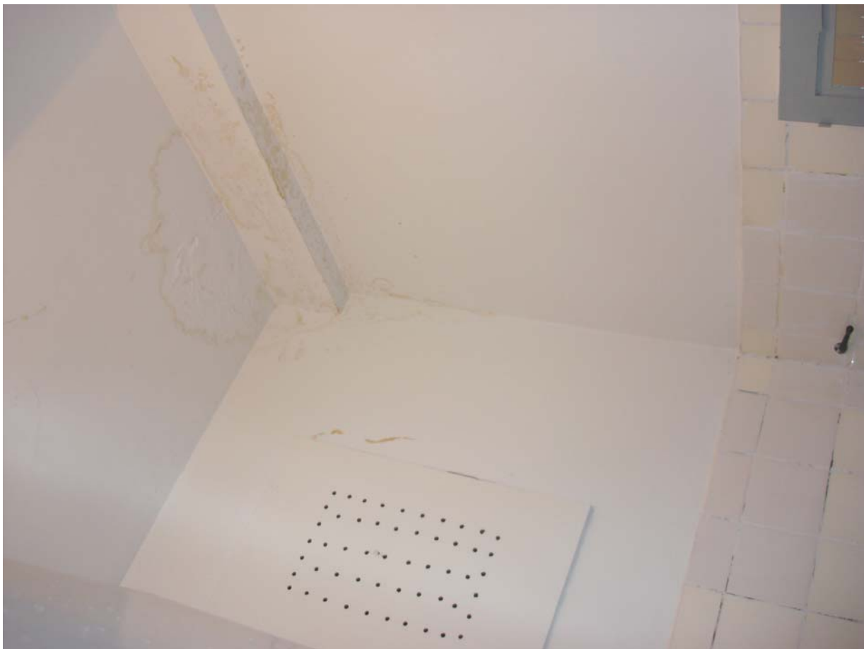
Foto N° 84: Observamos en la presente vista en una oficina del 6° piso en una esquina junto al cielorraso de una oficina rastros de humedad y mas abajo una salida de AA semi-tapada por lo mencionado en la foto anterior.
