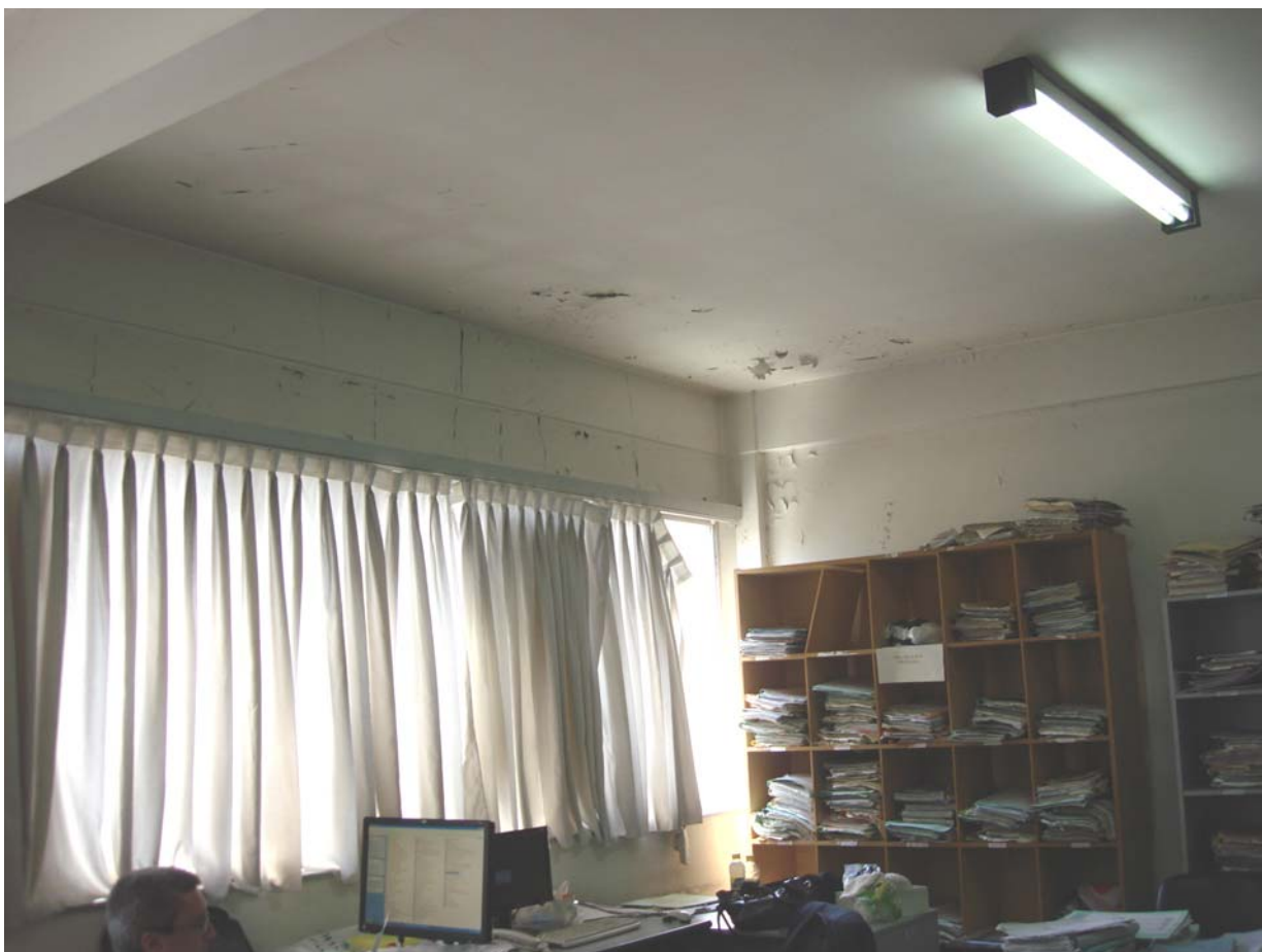
Foto N° 65: Observamos en la presente vista huellas de humedad en la pared del fondo y en el cielorraso con la pintura descascarada.
