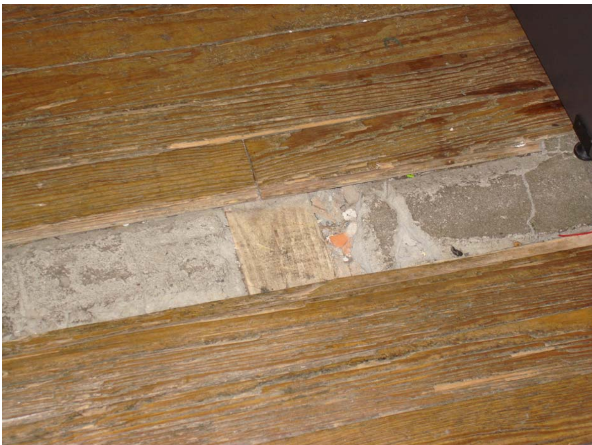
Foto N° 77: Observamos en la presente vista en una oficina del 7º piso el solado de madera de pinotea muy deteriorado y donde habría una pared colocaron un contrapiso de material.
