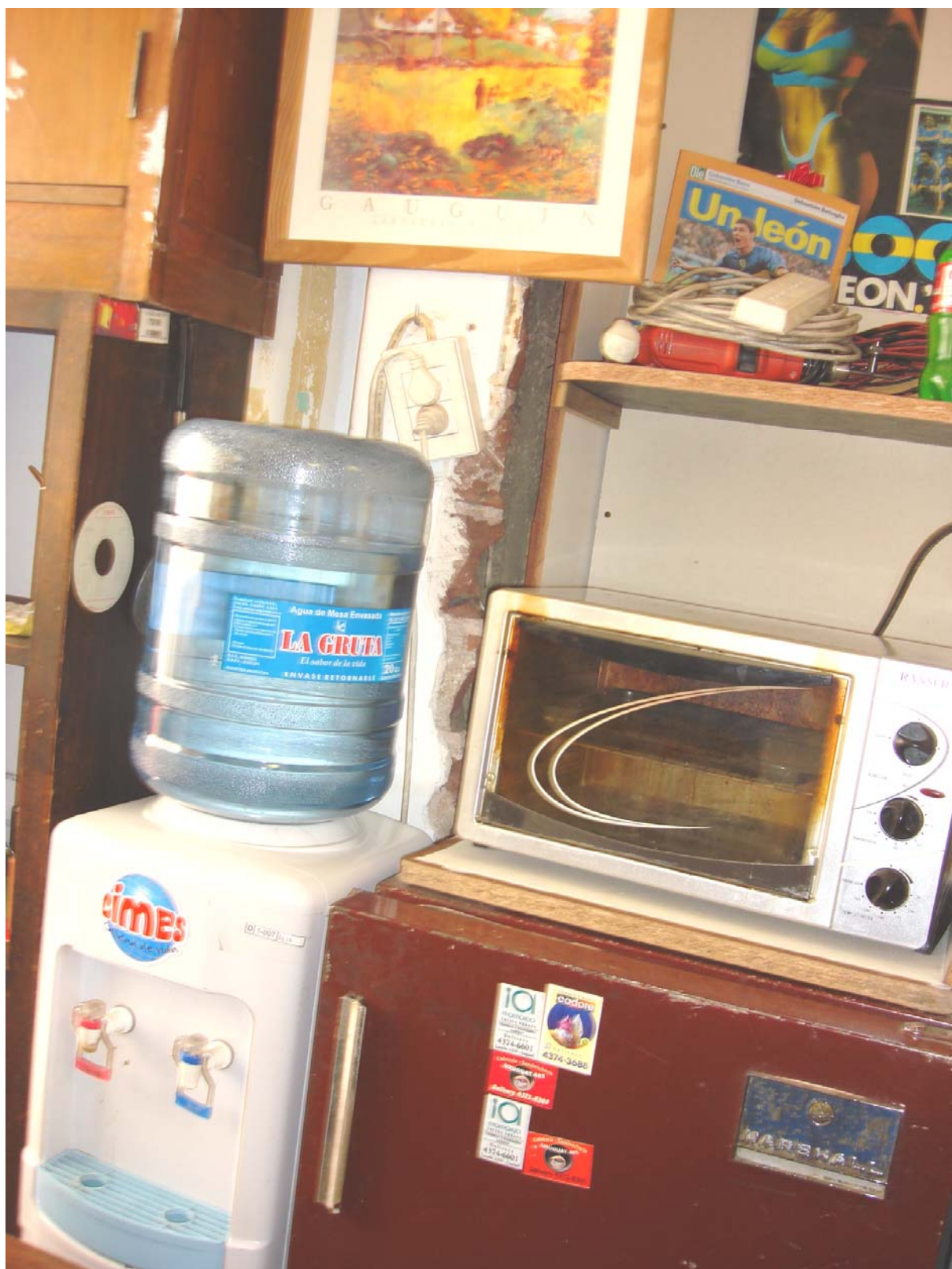
Foto N° 37: Observamos en la presente vista de una dependencia de “sistemas” usado como deposito de elementos en desuso, parte de la esquina de una pared deteriorada por un caño que pasa por ese lugar sin revoque y un toma de electricidad sin amurar colgado de un clavo por el cable de alimentación eléctrica al mismo.
