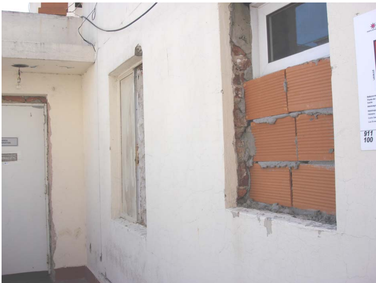
Foto N° 10: Observamos en la presente vista a la izquierda la entrada al salón de usos múltiples y a la derecha las ventanas que dan al interior del mismo con el mismo estado de hace un año y siete meses, ver fotos 9 y 12 del anterior informe 5.07.09.
