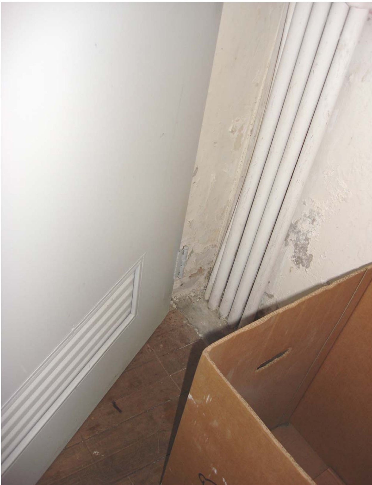
Foto Nº 58: Observamos en la presente vista en una esquina detrás de la puerta que da al AA huellas de humedad en las dos paredes.
