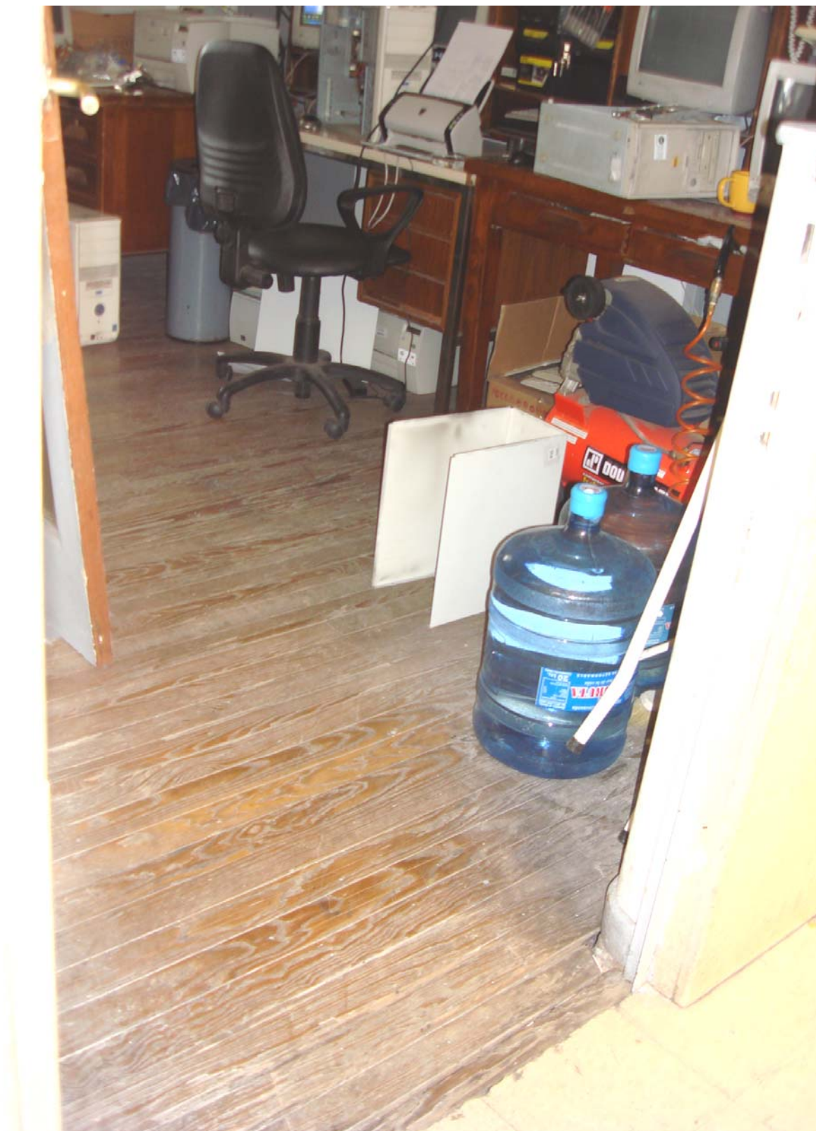
Foto N° 20: Observamos en la presente vista en una oficina de sistemas del 9º piso el piso de machimbre de tablillas de pinotea en mal estado.
