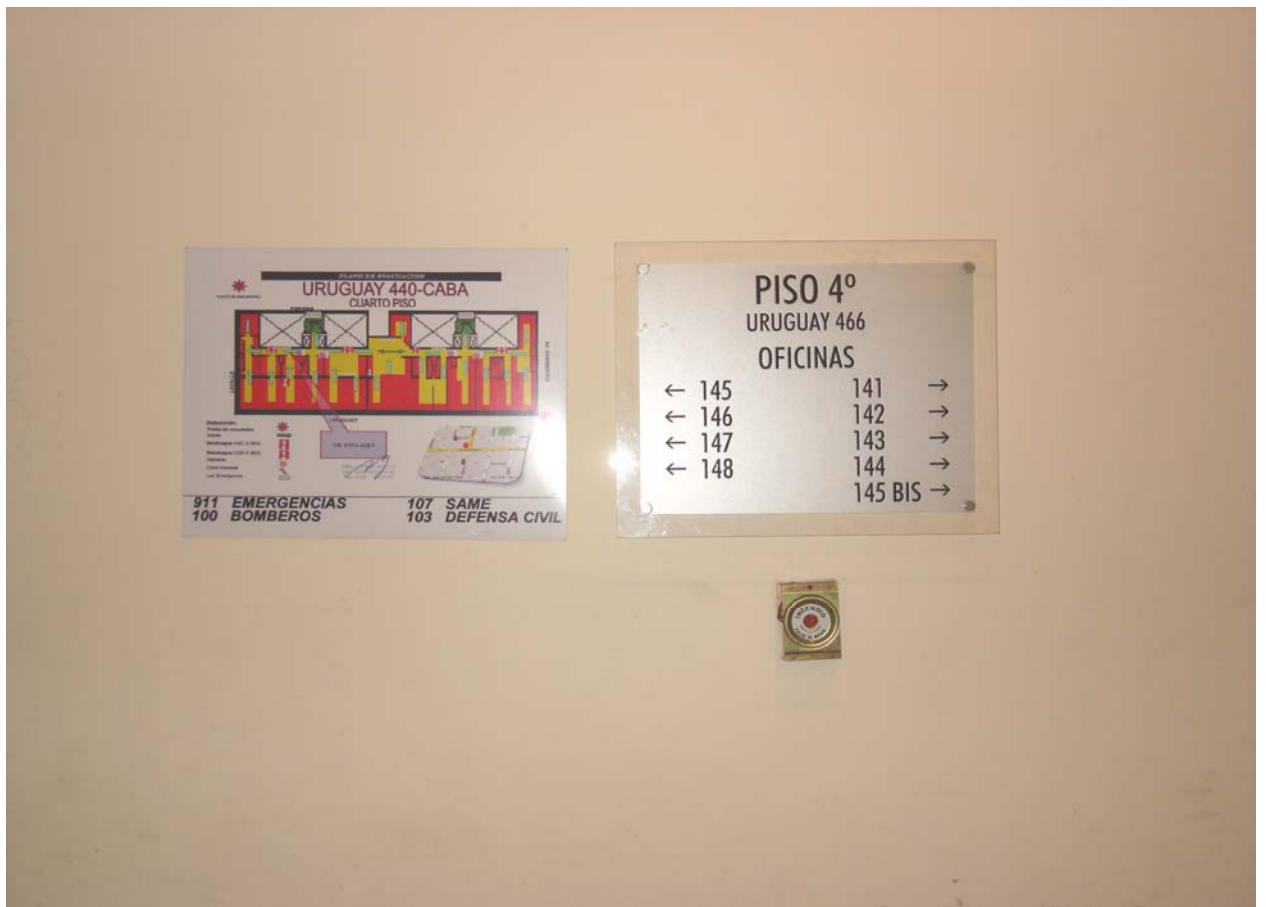
Foto N° 90: Observamos en la presente vista en el palier del 4º piso el plano de evacuación, un cuadro que orienta hacia donde están las diferentes oficinas y un pulsador del sistema de alarma contra incendio.
