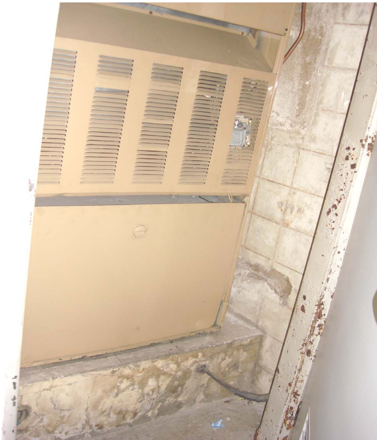
Foto N° 57: Observamos en la presente vista dentro de un pequeño recinto que da al pasillo común un equipo de AA con huellas de humedad en la banquina soporte del mismo, de donde sale un caño de electricidad.
