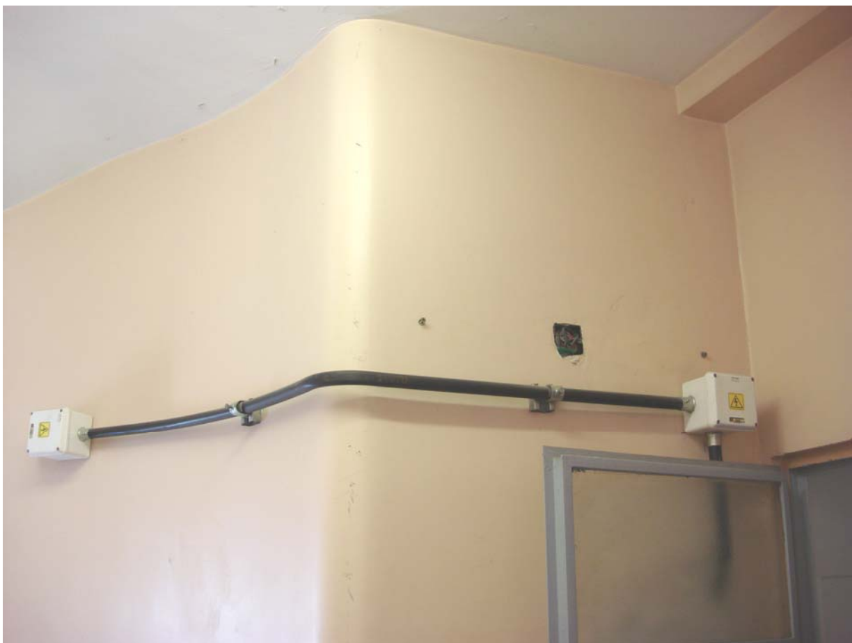
Foto N° 62: Observamos en la presente vista en el palier de la escalera del 8º piso sobre un caño de electricidad una caja de alimentación sin tapa de un artefacto de la luz de emergencia, el que no se encuentra colocado.
