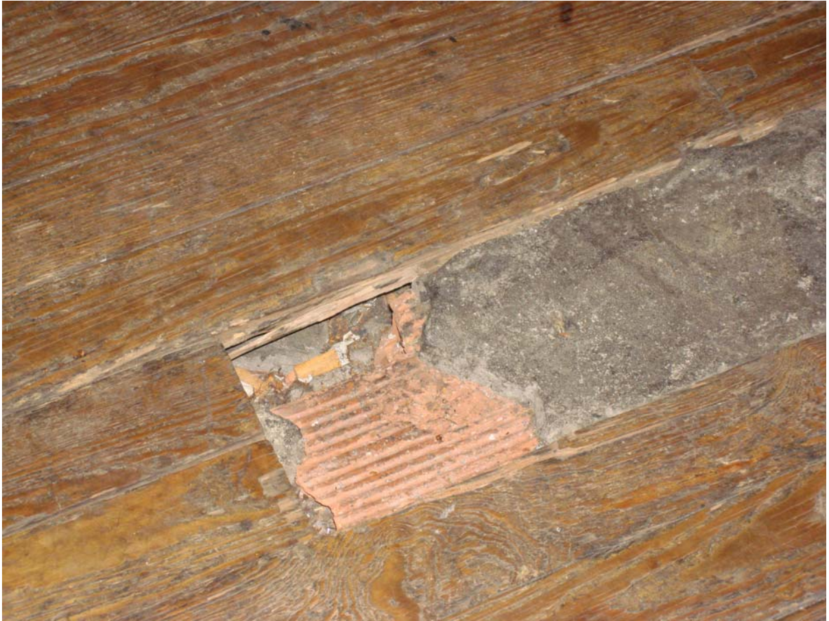
Foto N° 79: Observamos en la presente vista en una oficina del 6° piso el solado de madera de pinotea muy deteriorado y donde había una pared colocaron un contrapiso de material.
