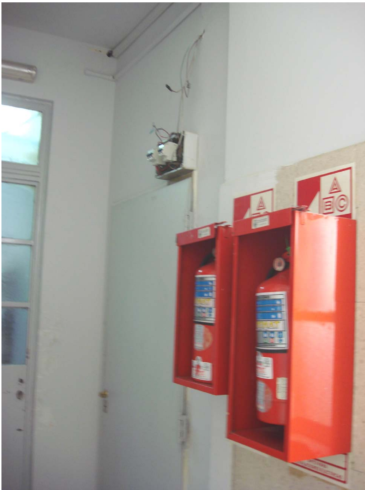
Foto N° 19: Observamos en la presente vista cables de electricidad expuestos que salen de un orificio en la pared y se conectan a una caja de electricidad con llaves de corte térmicas, a la derecha dos matafuegos sobre una chapa reglamentaria con la carga vigente dentro de cajas metálicas.
