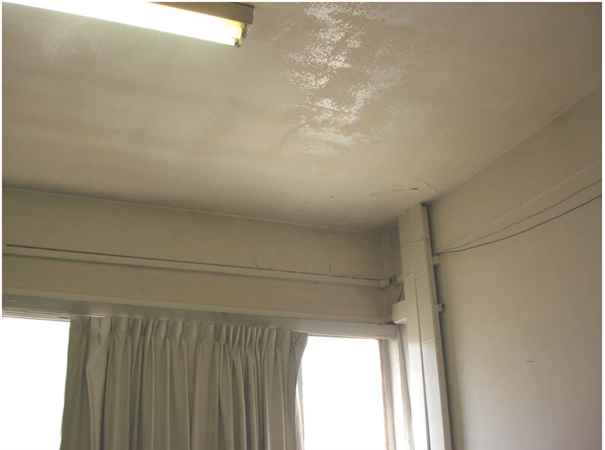
Foto N° 53: Observamos en la presente vista en una oficina del 8° piso cables de electricidad expuestos que salen de un cablecanal y cuelgan por la pared. En esa esquina del cielorraso se pueden ver rastros de humedad en las paredes y el techo.
