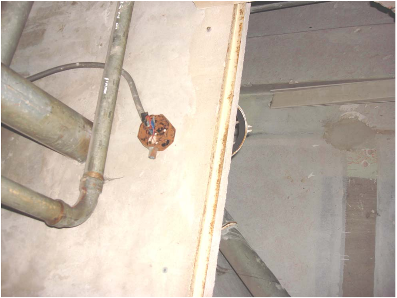
Foto Nº 96: Observamos en la presente vista del sótano una caja de derivación de electricidad que muestra los cables expuestos y encintados.
