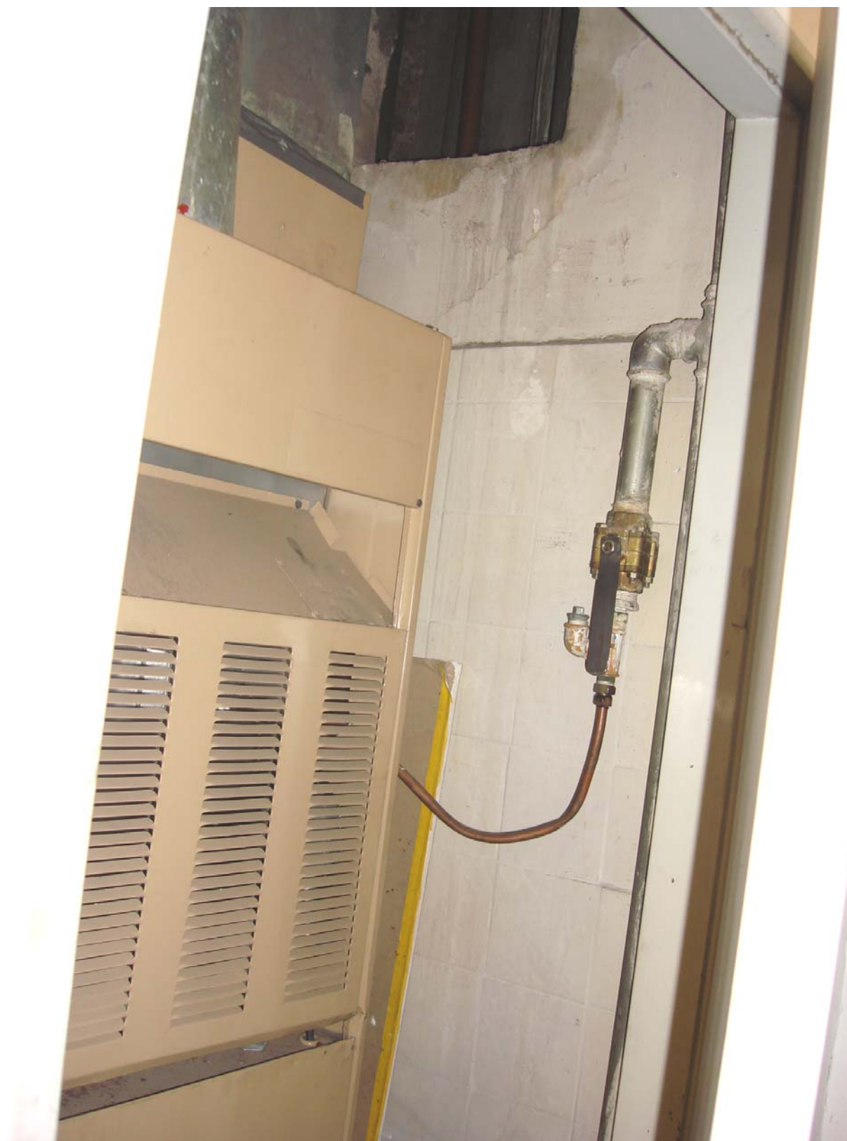
Foto N° 49: Observamos en la presente vista un equipo de AA con huellas de humedad en la parte superior de la pared.
