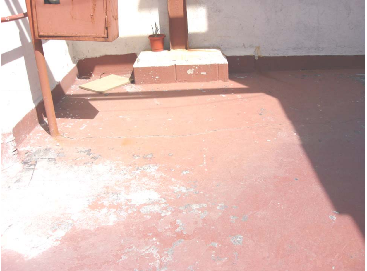
Foto N° 3: En la presente vista de un sector de la terraza se comprueba lo observado en la foto N° 13 sobre el piso de la terraza con pintura descascarada y una fisura por donde filtra agua al piso inferior .
