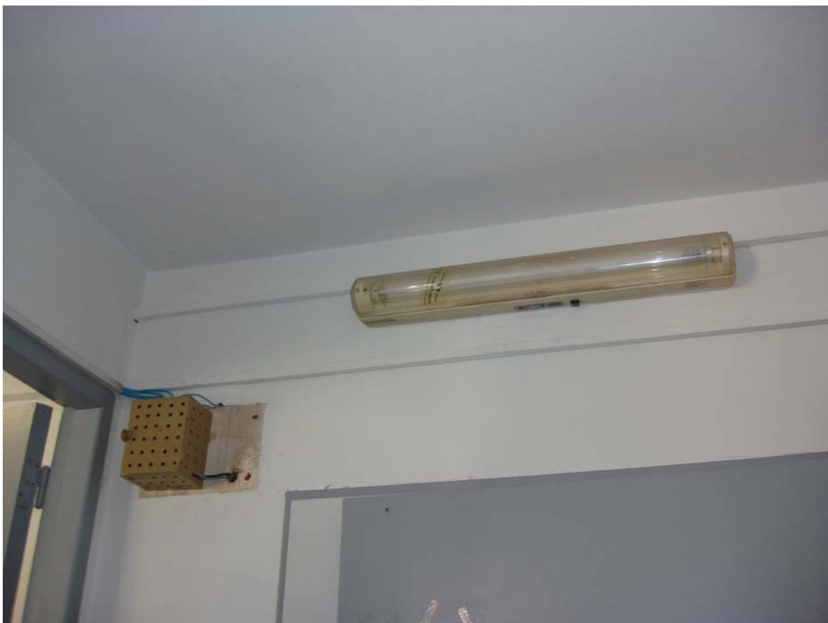
Foto Nº 75: Observamos en la presente vista en una oficina del 7º piso un artefacto de la luz de emergencia y a la izquierda una caja de la que salen y entran cables de electricidad expuestos.
