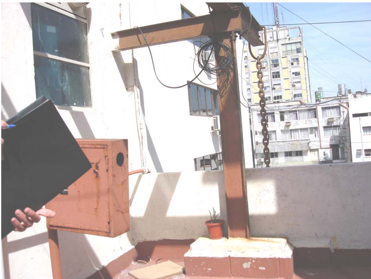
Foto N° 1: En la presente vista de un sector de la terraza se comprueba lo observado en la foto N°7 del anterior informe (5.07.09) sobre la existencia del mismo gabinete del sistema de hidrantes contra incendio (que no funciona ) con la llave de paso, la manguera y la lanza.
