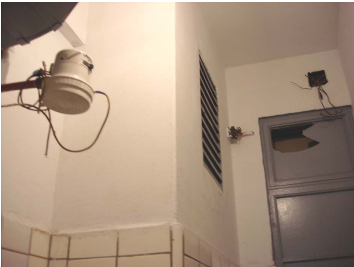
Foto N° 24: Observamos en la presente vista en un baño del 9º piso una ducha con los cables de la conexión eléctrica expuestos.
