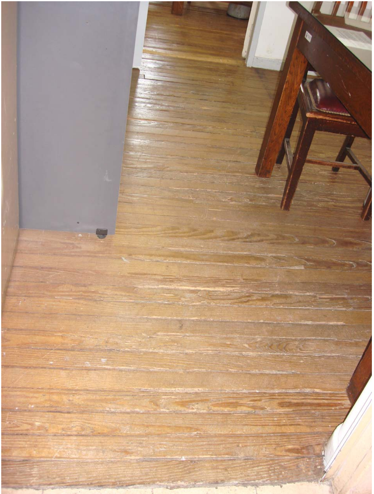
Foto N° 54: Observamos en la presente vista en una oficina del 8° piso el solado de machimbre de madera de pinotea muy deteriorado, en varios sectores se hunden al paso de las personas.
