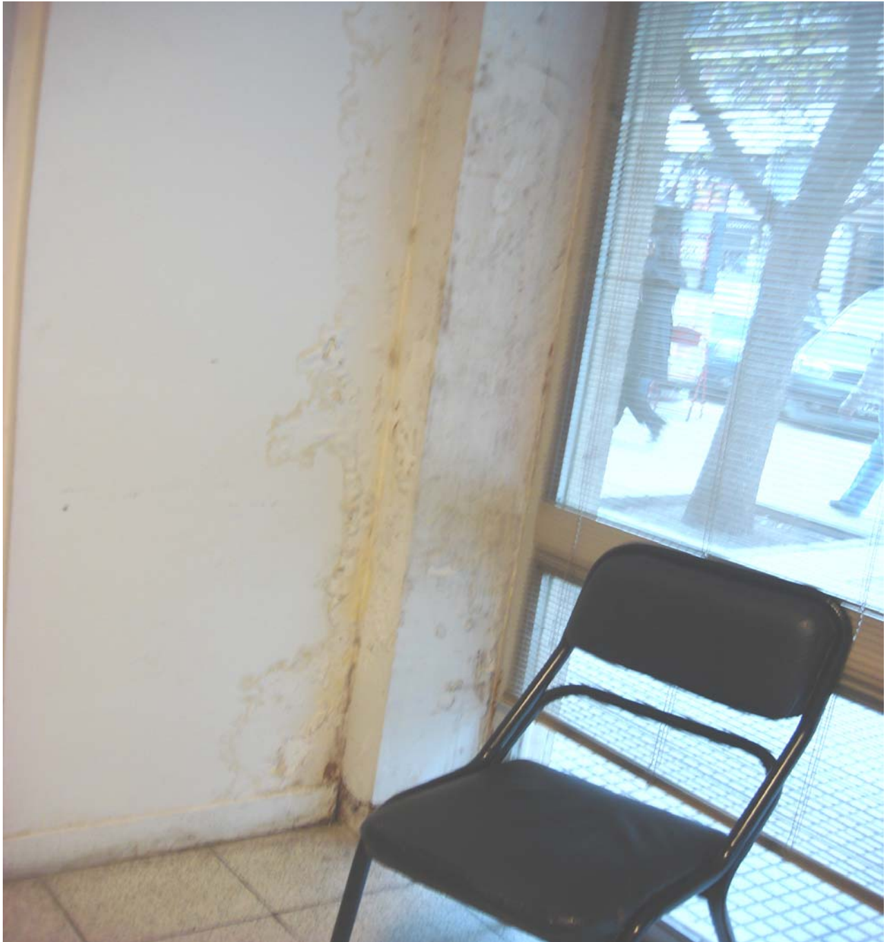
Foto N° 100: Observamos en la presente vista de el local de planta baja donde se encuentra el equipo de bombas y tanque de agua contra incendio, se puede ver en la pared los rastros de humedad de filtraciones de agua ya denunciado en el informe anterior 05.07.09.
