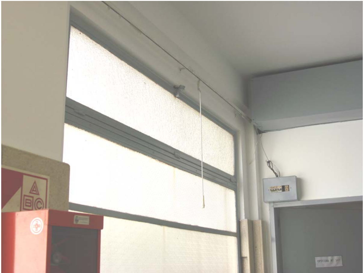
Foto N° 78: Observamos en la presente vista en una oficina del 6° piso una caja con llaves térmicas y un disyuntor de electricidad y en la parte superior salen varios cables de electricidad expuestos .
