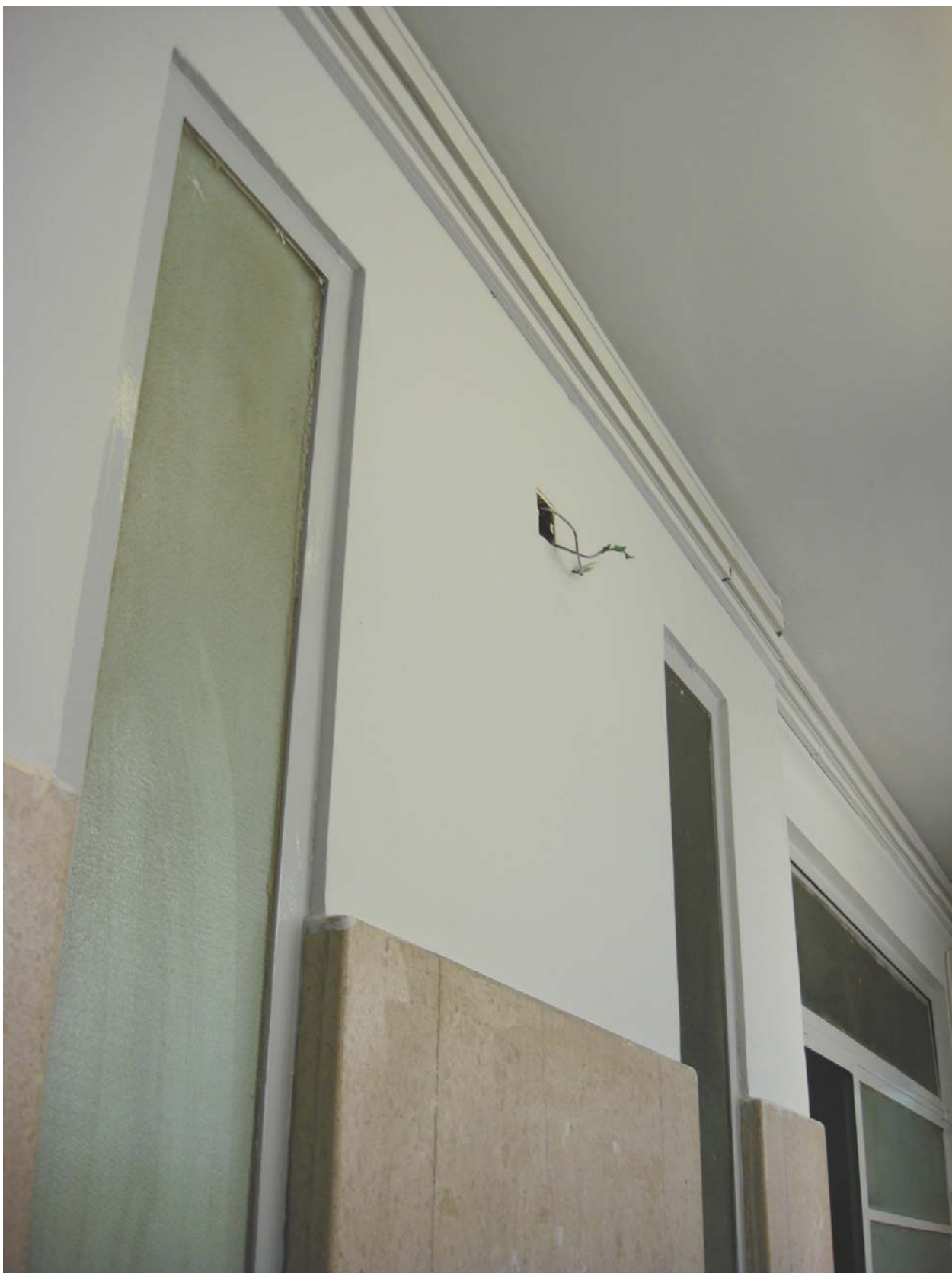
Foto N° 21: Observamos en la presente vista en una pared el palier del 9º piso una boca de la cual salen dos cables de electricidad expuestos y encintados .
