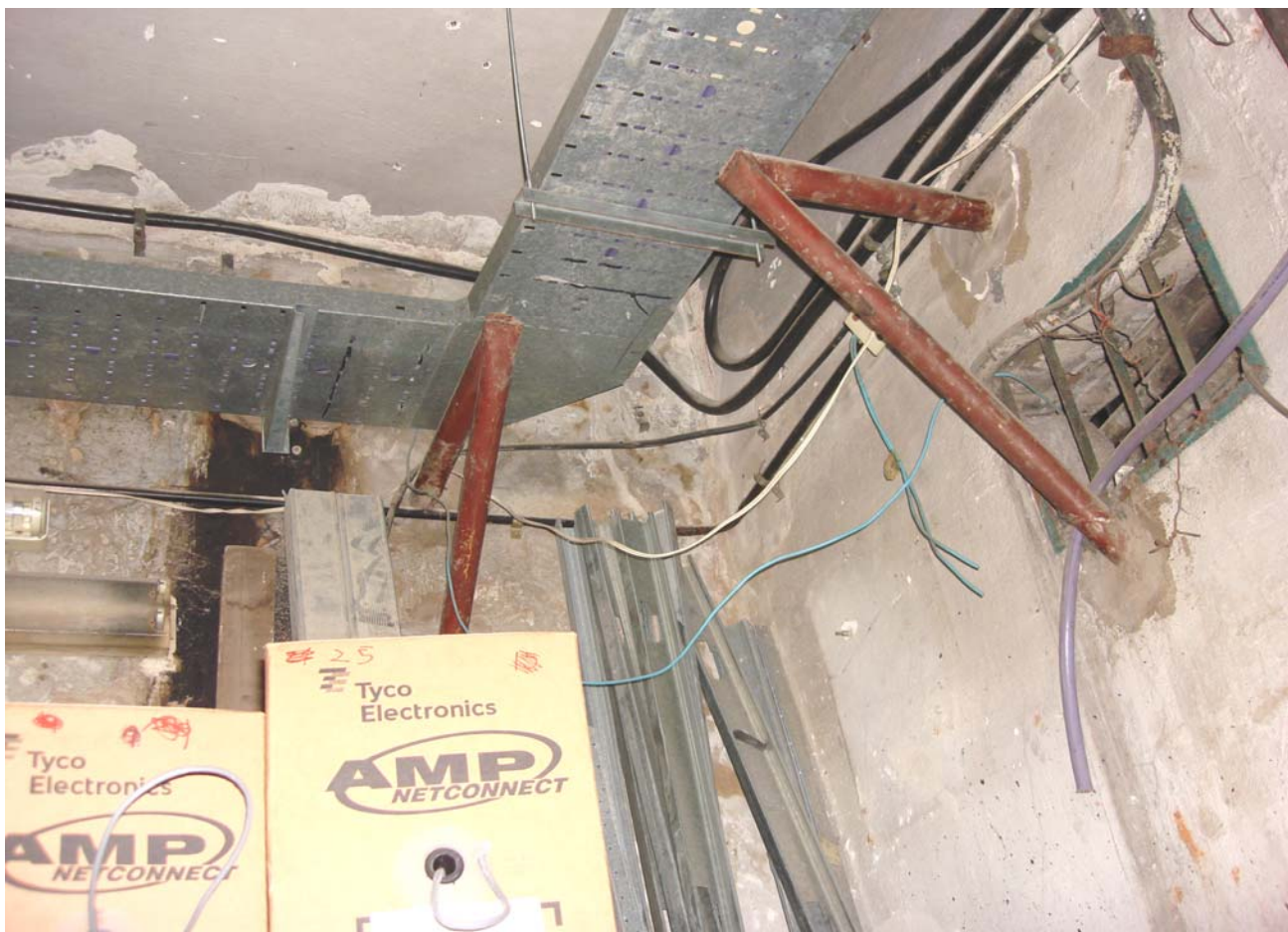
Foto N° 95: Observamos en la presente vista del sótano una pared deteriorada con rastros de humedad, cables de electricidad expuestos y material de construcción depositado en el lugar.
