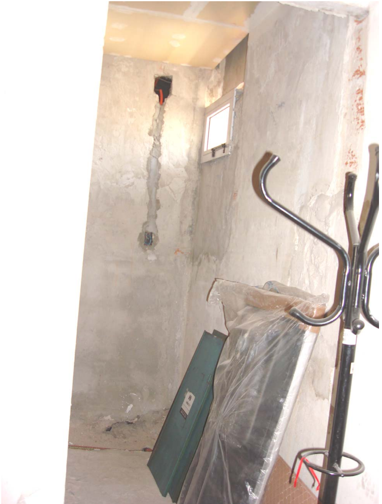
Foto N° 8: Observamos en la presente vista otro sector del salón de usos múltiples con detalles de albañilería y de electricidad a medio realizar con cables de electricidad expuestos (sin conectar).
