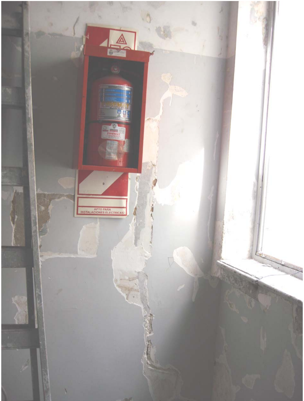
Foto N° 35: Observamos en la presente vista dos paredes del 9º piso deterioradas por efecto de la humedad y en una un matafuego con la carga vigente.
