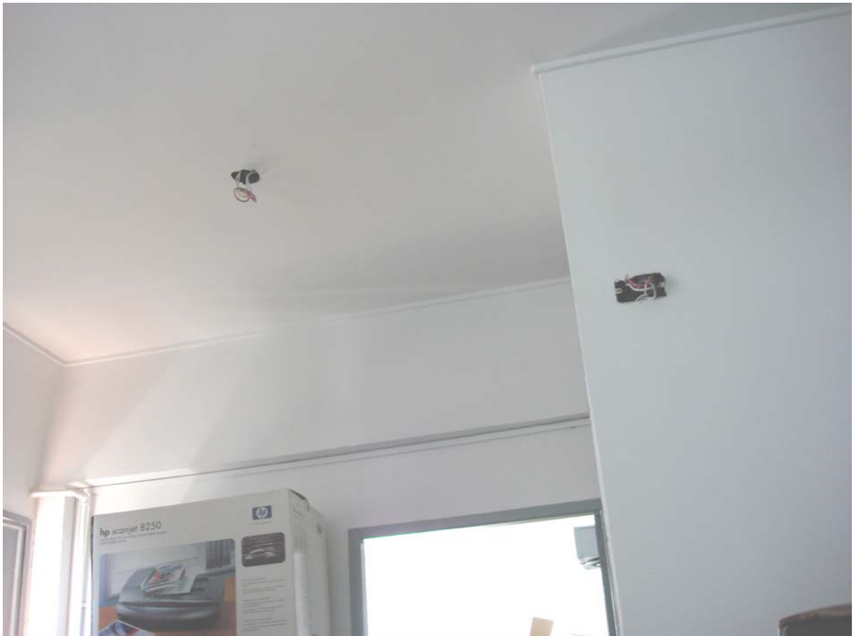
Foto N° 25: Observamos en la presente vista en una oficina del 9° piso tres bocas de electricidad sin las tapas, de las que salen cables de electricidad expuestos .
