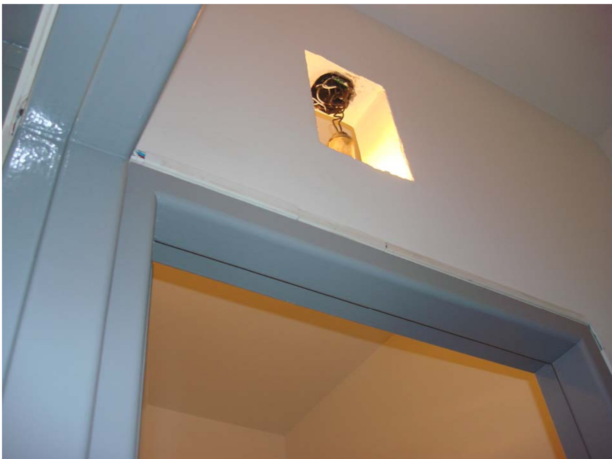
Foto N° 50: Observamos en la presente vista en un sanitario del 8° piso un centro de iluminación sin tapa ubicado en un nicho en medio de la pared del que salen varios cables de electricidad expuestos, algunos encintados, dos de los cuales alimentan un portalámpara que ilumina el gabinete y la antecámara.
