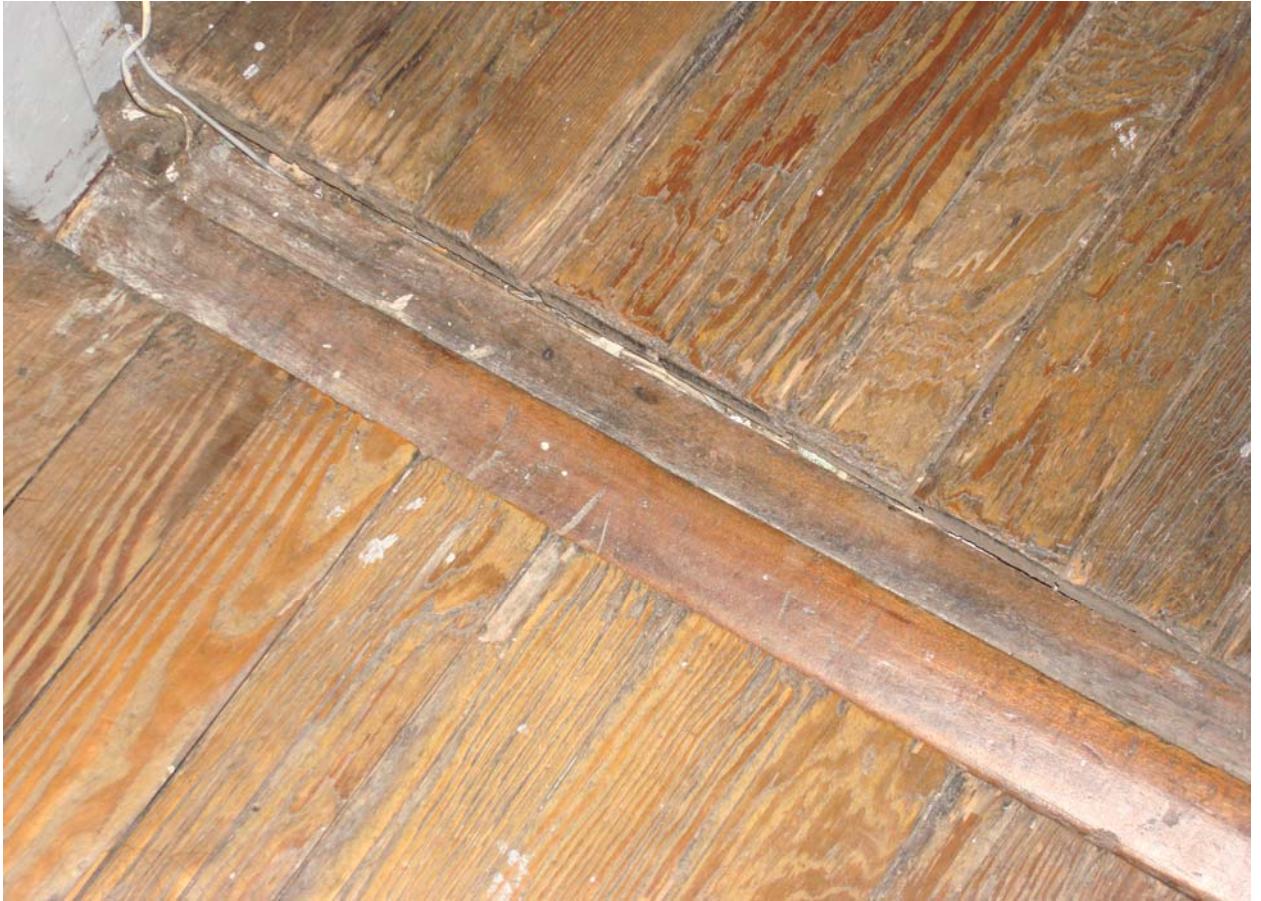
Foto N° 81: Observamos en la presente vista en la unión de dos oficinas del 6° piso el solado de madera de pinotea muy deteriorado y paralelo al umbral en una separación de la unión de pisos pasan cables de electricidad expuestos .
