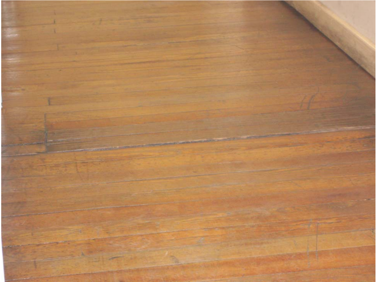
Foto N° 94: Observamos en la presente vista en el 1º piso el solado de pinotea con varias maderas del machimbre separadas, la superficie muy despareja y en algunos sectores el piso se hunde al paso de la gente.
