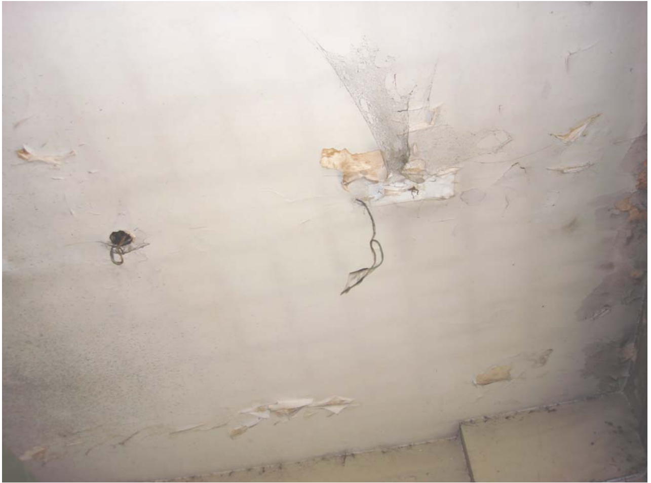
Foto N° 102: Observamos en la presente vista del local de planta baja donde esta el equipo de bombeo contra incendio en el cielorraso dos centros de electricidad sin tapas y de donde salen cables de electricidad expuestos y encintados y en varios sectores huellas de humedad.
