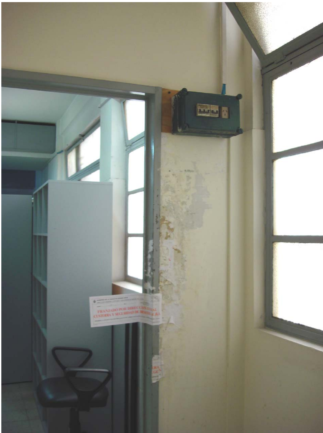
Foto N° 64: Observamos en la presente vista huellas de humedad en la pared junto al marco de la puerta y en la parte superior una caja con dos llaves térmicas de corte eléctrico.
