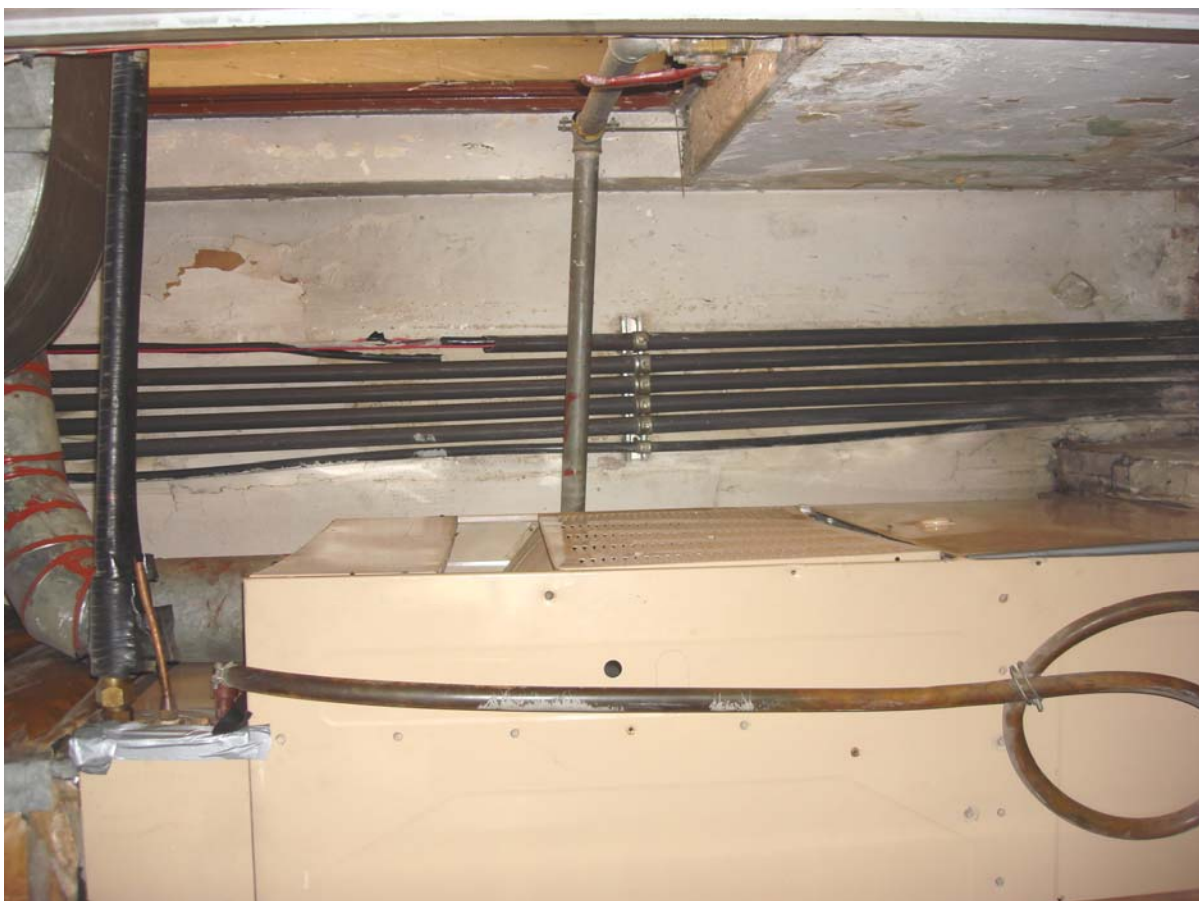
Foto N° 87: Observamos en la presente vista en el 5º piso un equipo de AA recién reparado colocado dentro de un lugar cerrado el que muestra las marcas de humedad producidas antes de la reparación del mismo.
