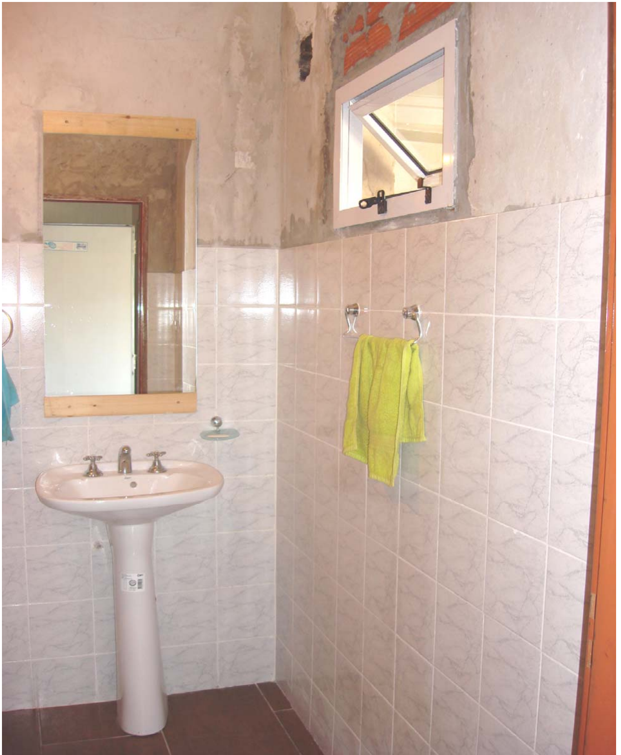
Foto N° 4: Observamos en la presente vista un baño en el salón de usos múltiples que en el anterior informe (foto n° 18) se encontraba a medio terminar hoy después de un año y siete meses presenta todavía partes sin revocar y con una boca de inspección eléctrica sin la tapa y con los cables expuestos . Es de notar que este sanitario esta en uso en la actualidad.
